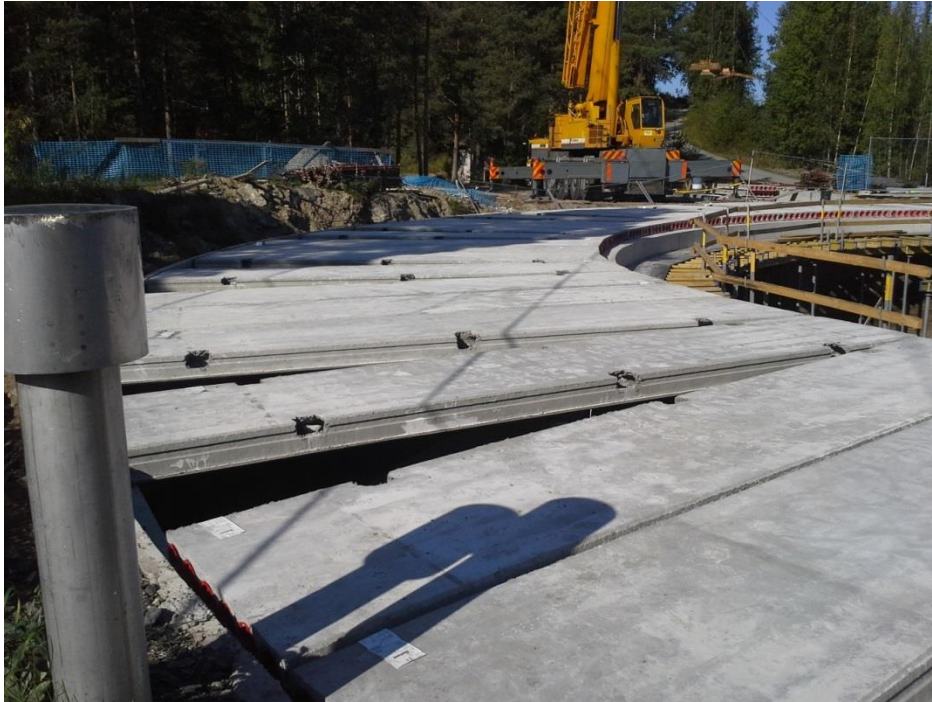
Kuva 12. Ontelolaattoja, sekä työtaso.
