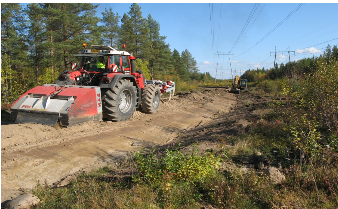
Kuva 6. Kuvassa järeä traktori murskaamassa kiveä. Lisälaitteena edessä hara ja perässä murskain. Kauempana edessä näkyy kaivinkone haraamassa ojaa. Lisäksi mukaan tarvitaan tiehöylä, jossa lisälaitteena täry tiivistykseen, sekä kuorma-auto, jolla hoidetaan kalusto- ja materiaalikuljetukset. (Tirkkonen 2013-08)
