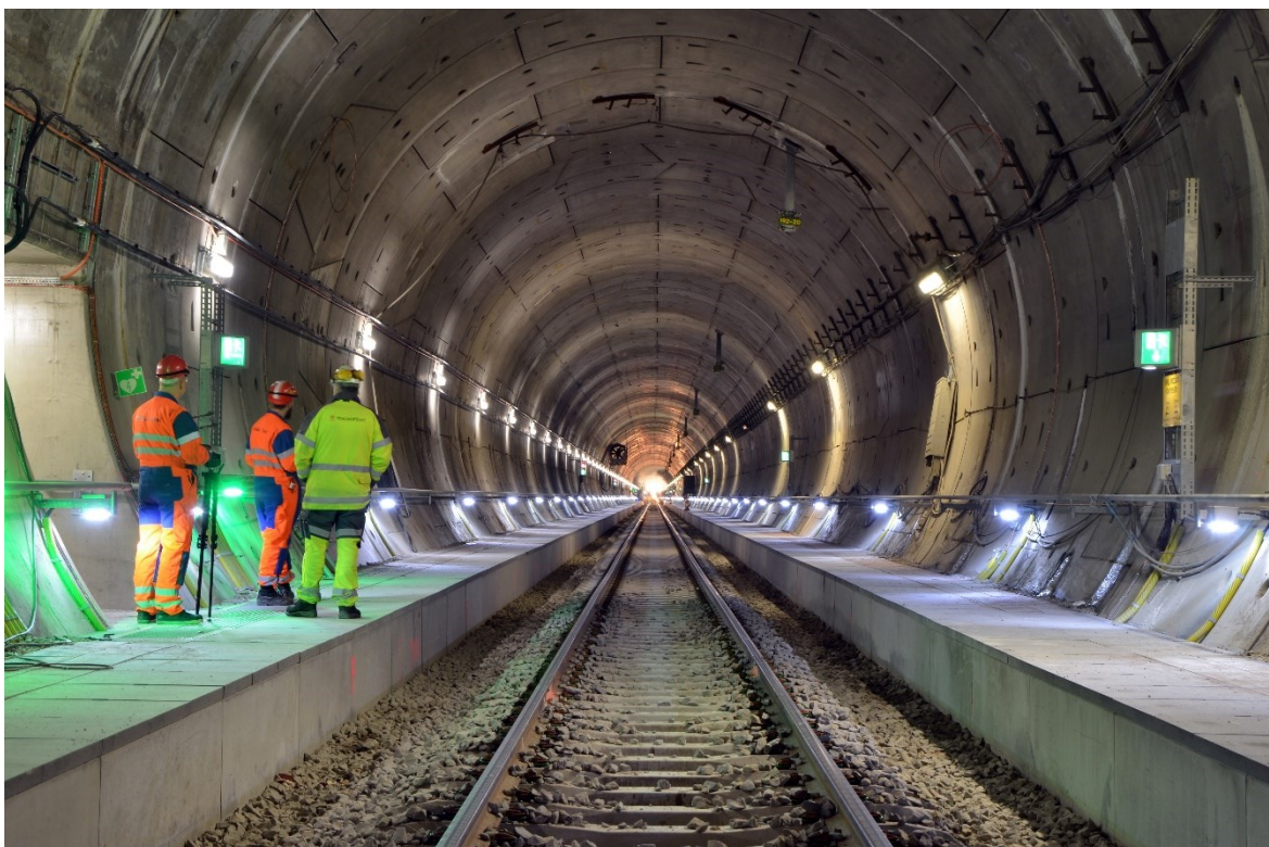
Bild 7. Ena tunneln genom Hallandsåsen med färdigt spår. Trafikverket 2015.
