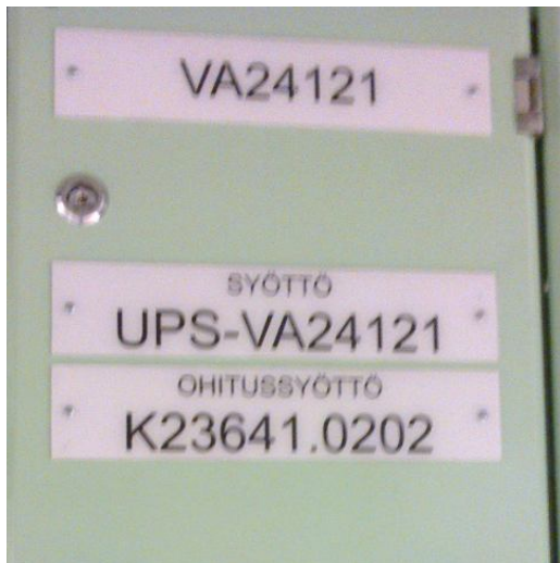
Kuva 12. Sähkön syöttö UPS kaapista. UPS:n ansiosta sähkönsyöttö ei katkea mahdollisen sähkökatkon aikana (Outokumpu Stainless Oy 2015).
