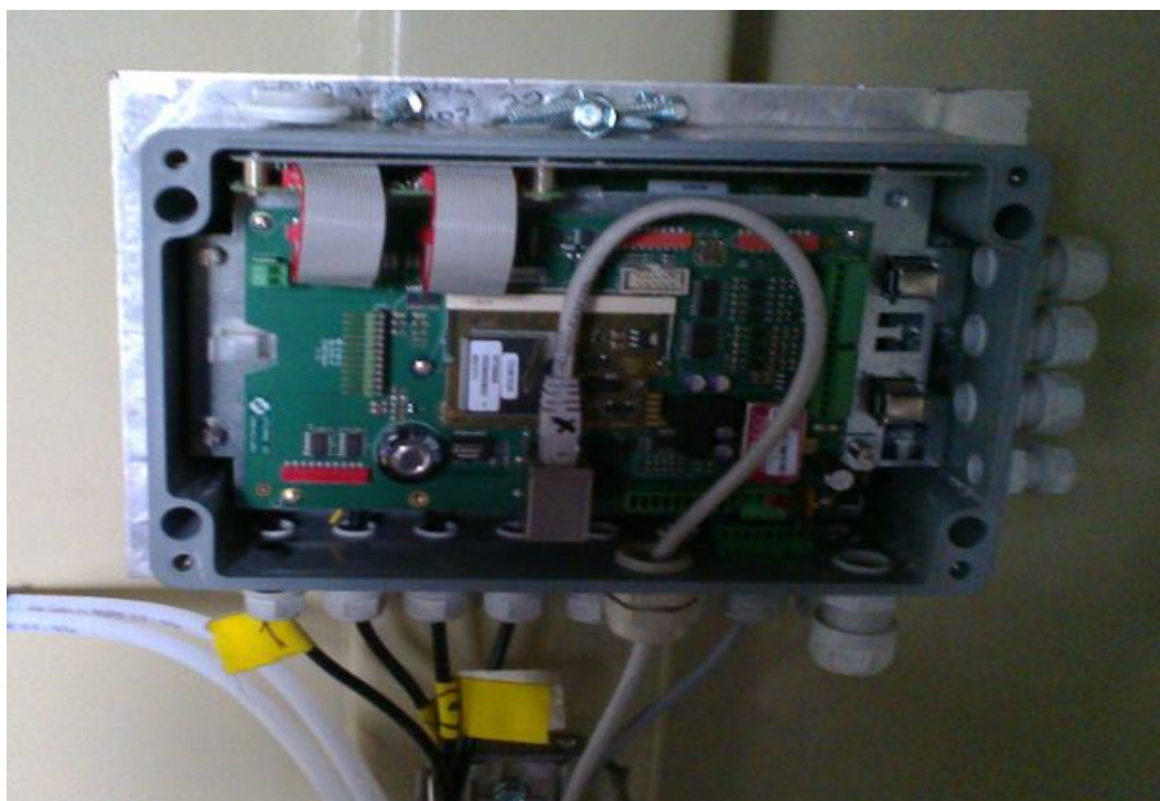
Kuva 14. Hiilivaaka on Ethernet yhteydellä asennettu.
