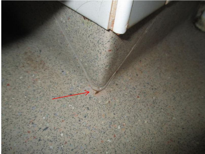
Kuva 4. Reikä maton saumakohdassa
