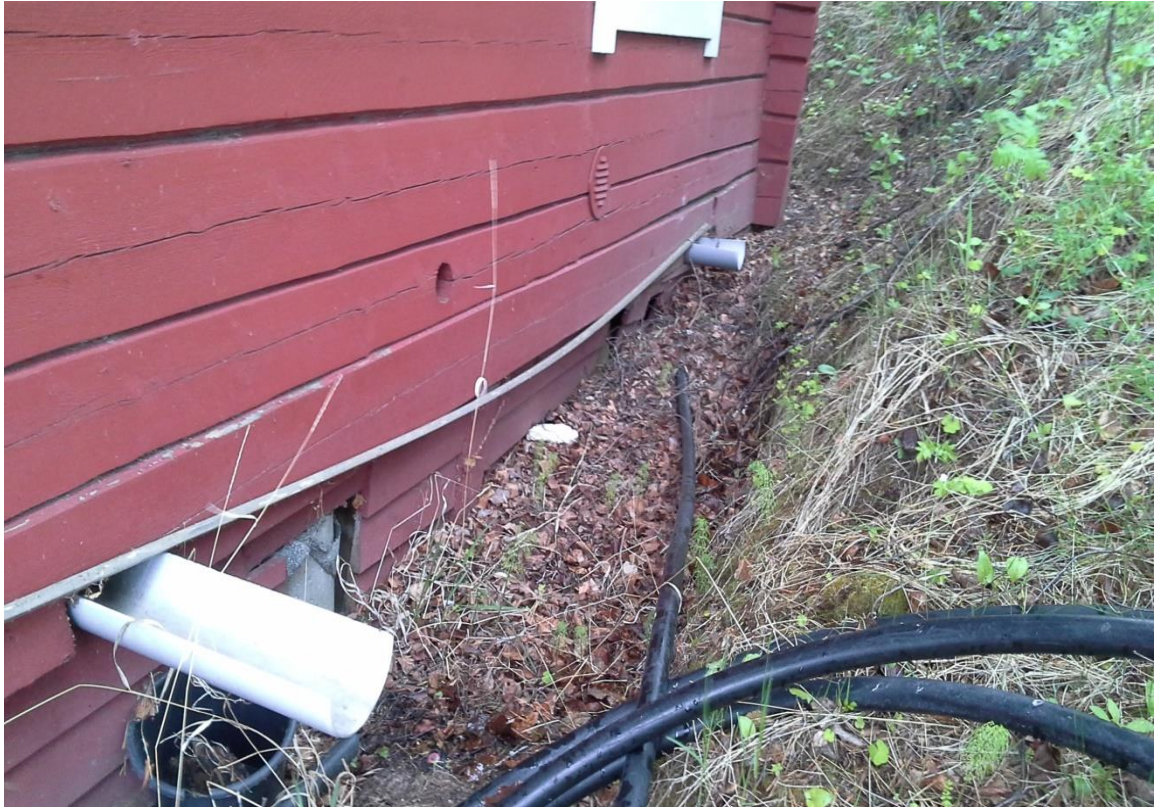
Kuva 29. Ärjänsaaren kahvion saunasta puuttuu pesuvesien maahanimeytyskaivo.
