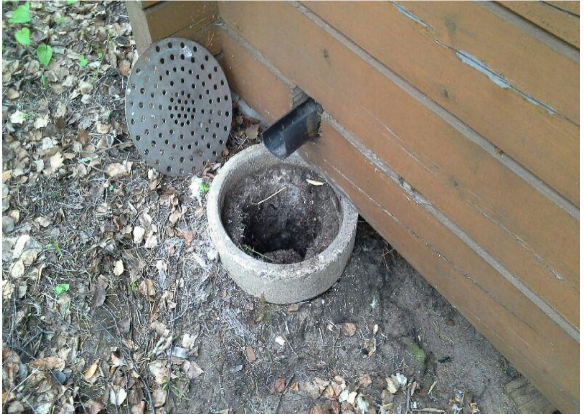
Kuva 27. Hirsisaunan pesuvesien maahanimeytyskaivo.
