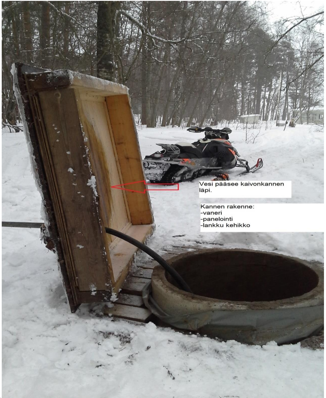
Kuva 13. Sade- ja sulamisvesi pääsee kaivon kannen läpi.
