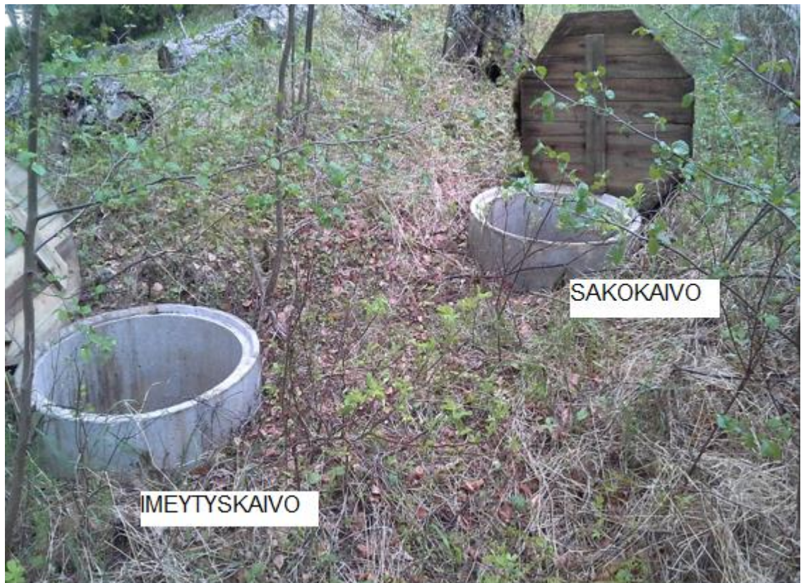
Kuva 26. Ärjänsaaren kahvion sako- ja imeytyskaivo.
