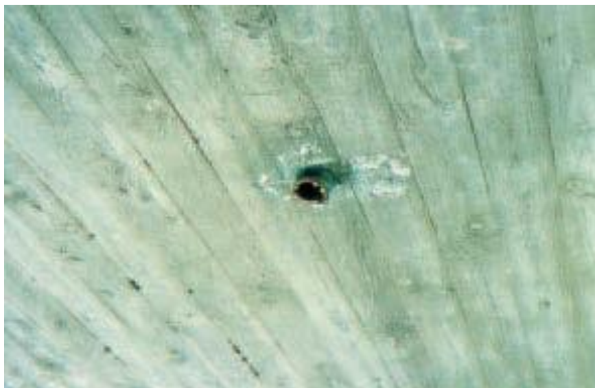
Kuva 7. Vesivuoto tippuputken ulkopuolelta (Kuva: Sillantarkastusohje, Tiehallinto 2004).
