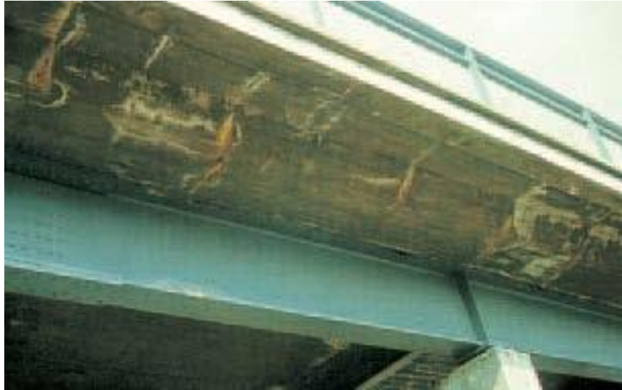
Kuva 8. Kansilaatan vesivuoto (Kuva: Sillantarkastusohje, Tiehallinto 2004).
