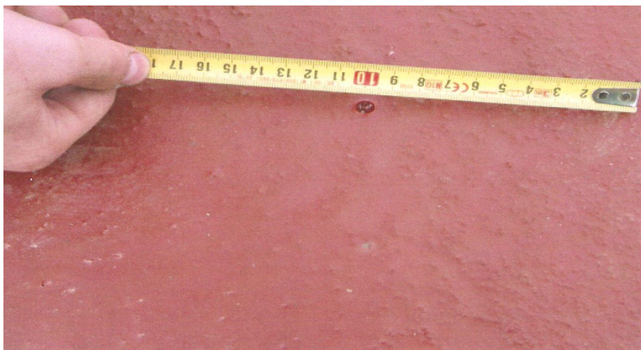
Kuva 3. Tavallinen huokosreikä epoksissa. (Kuva: Siltojen ja muiden liikennöityjen alueiden vedeneristystöiden valvojan ja työnjohtajan koulutus 25. ja 26.3.2013, Hämeenlinna. Luentoaineisto, kehittämisspäällikkö Jouko Lämsä, Liikennevirasto, Taitorakenneyksikkö).
