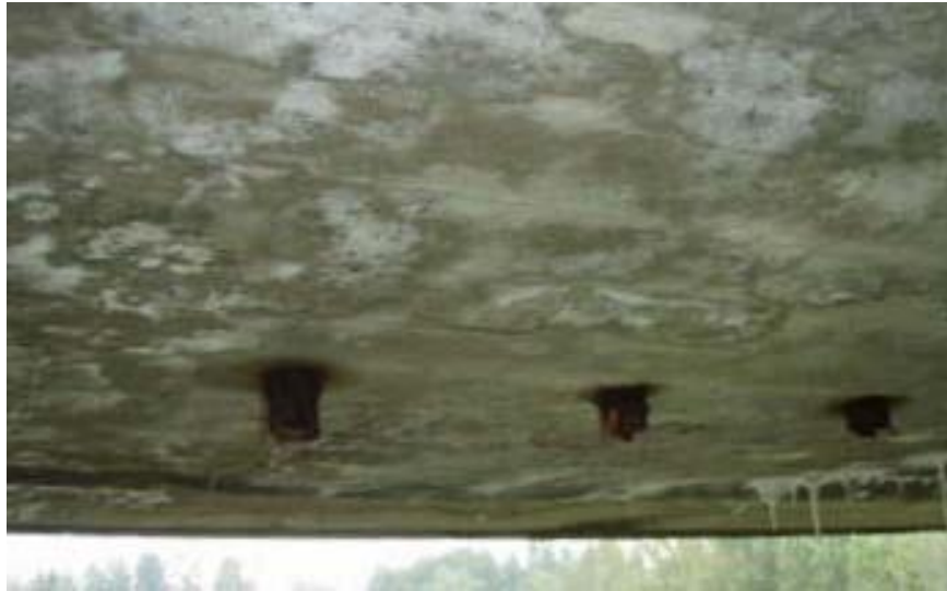
Kuva 6. Vuotavat halkeamat, kalkkipuikot ja kalkkiläiskät ovat merkkejä laajoista vedeneristyksen vaurioista (Kuva: SILKO 1.801 Kannen pintarakenteet, vedeneristykset 04/11).
