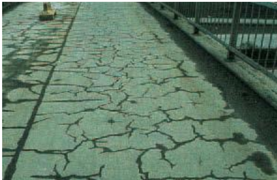
Kuva 5. Verkkohalkeamaa päällysteessä (Kuva: Sillantarkastusohje, Tiehallinto 2004).
