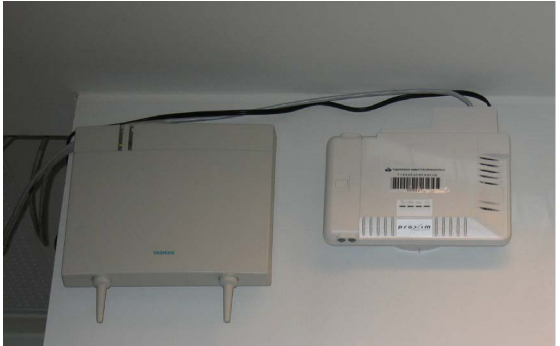
Kuva 11. Tukiaseman käytäväasennus (tukiasema oikealla)
