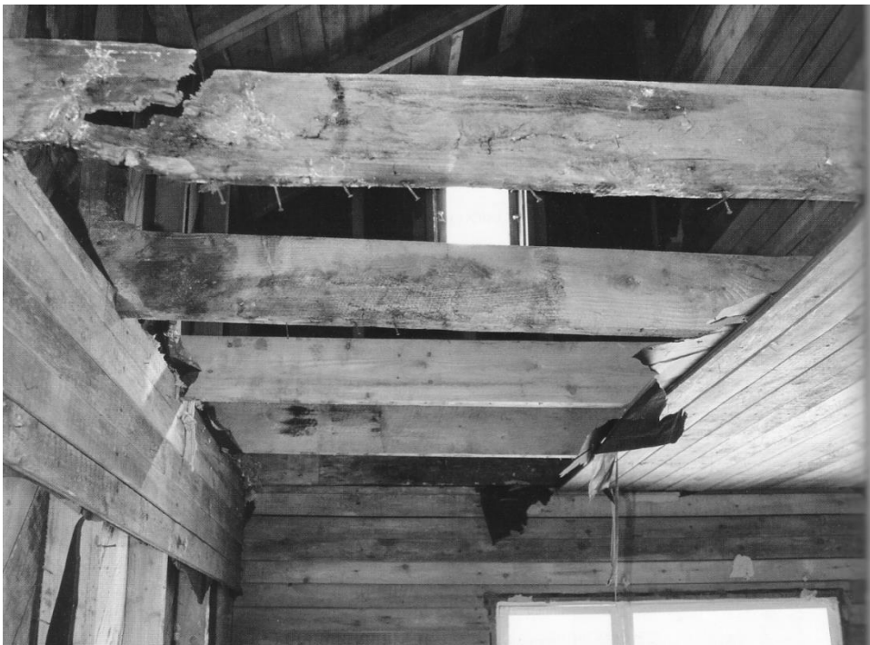
KUVA 4. Lahovikaa rakennuksen välipohjassa (2, s. 50)
