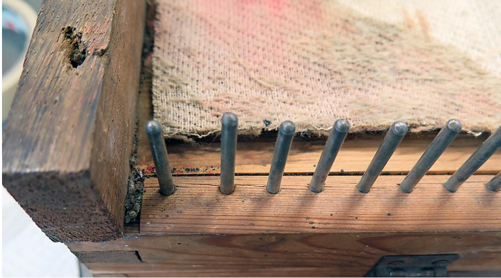
Kuva 19. Kielitukin pinta ennen puhdistusta. (Niemi 2015)
