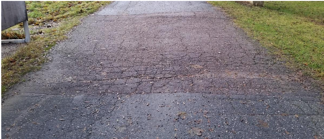
Kuva 10. Nuolemontien pysäkin viereinen vaurio-osuus.
