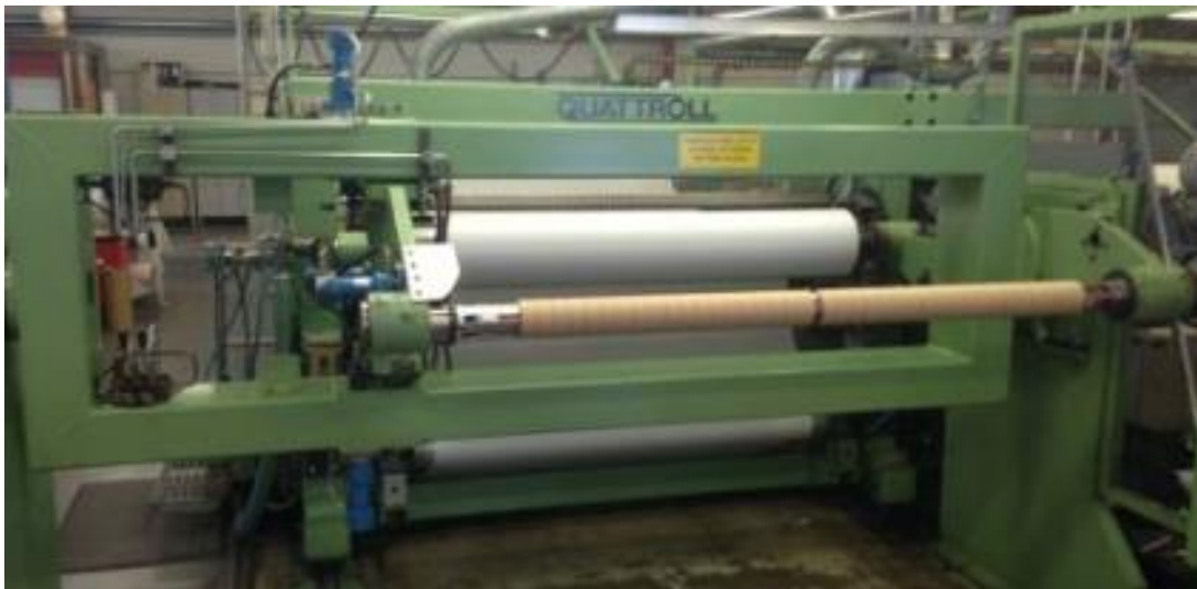
KUVA 10. Karuselli pyörähtää käytettäessä 180° aiheuttaen puristumisvaaran, mikäli ihminen on mennyt karusellin alle tai väliin (Kuva: Paperitehdas)
