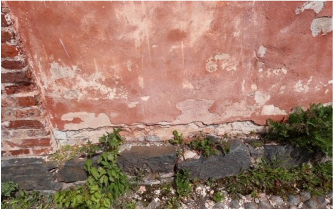
Kuva 5. Sokkelin yläpuolisia vaurioita.
