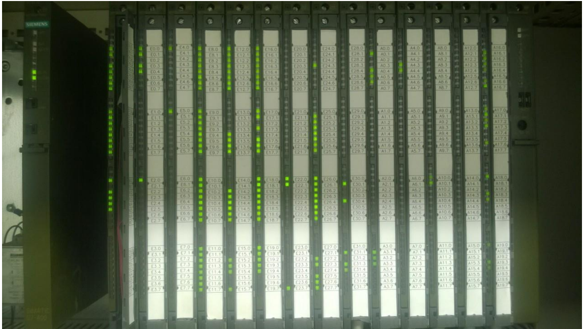
Kuva 11. S7-400 -sarjan laajennuskehikkoon liitettynä liitäntämoduuli ja signaalimoduuleja (Heinonen, 2015)
