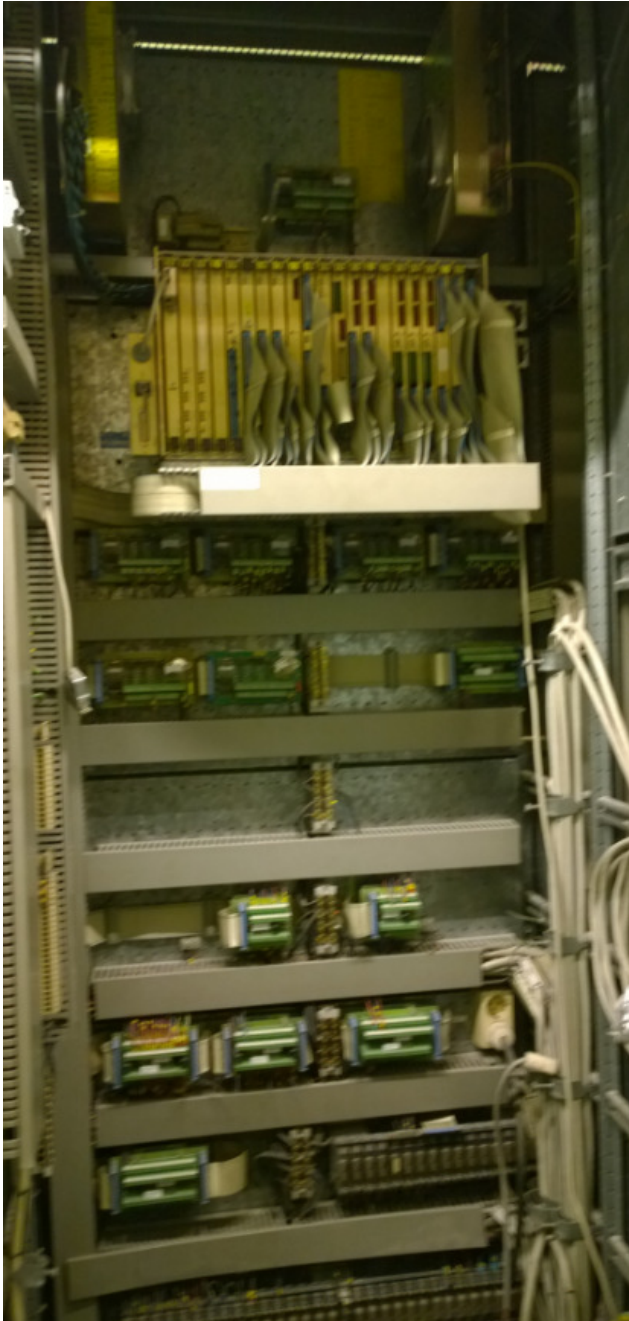
Kuva 2 Selma 2 -automaatiojärjestelmän laitekaappi
