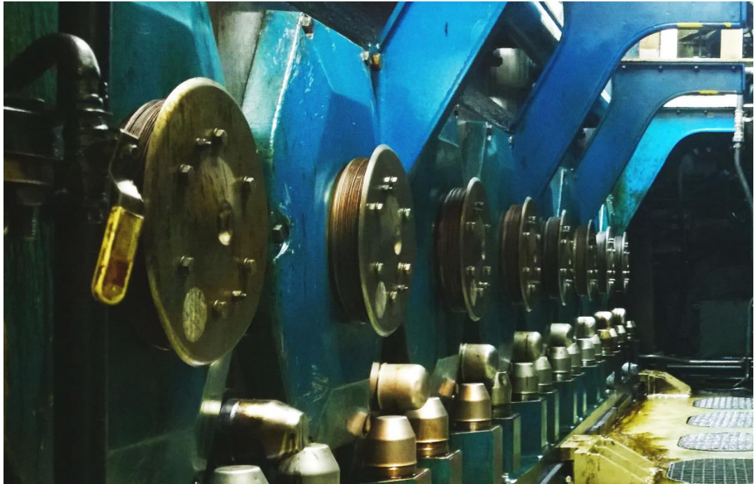
Kuva 10. Kampikammion räjähdysluukut (Stenman 2014.)
