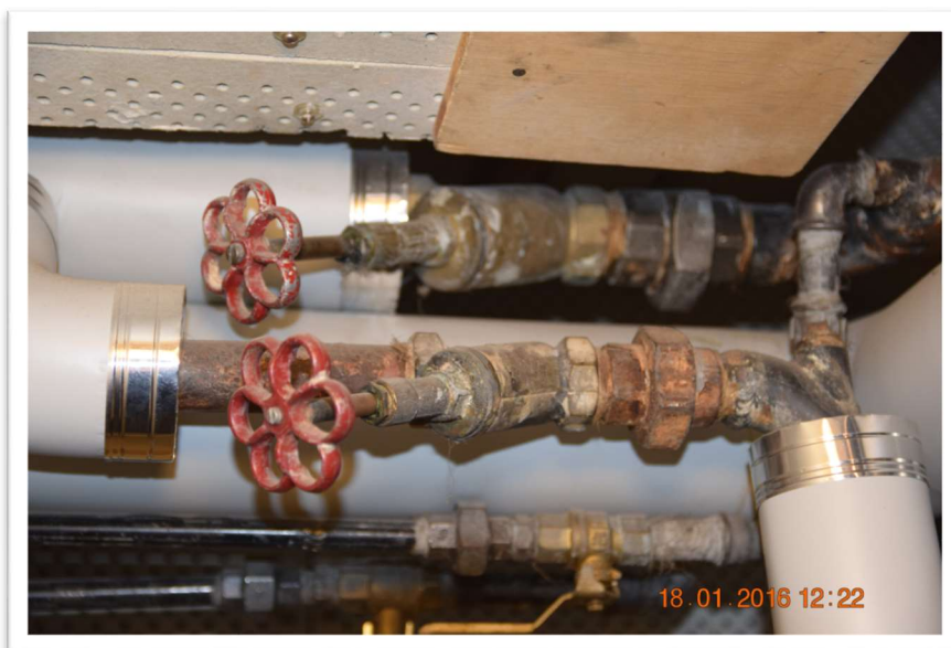
Kuva 30. Kuvassa on tuloilmakoneen lämmityspiirin vanhat venttiilit.
