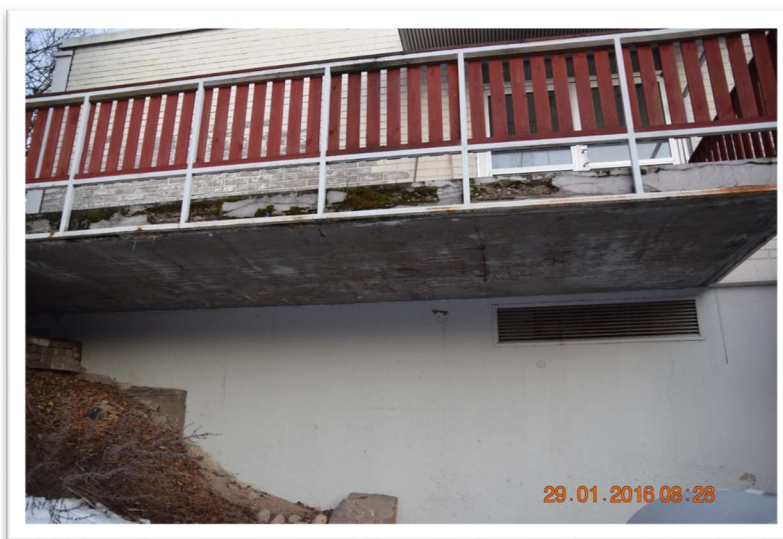
Kuva 46. C-siivestä pihalle johtava kulkutie on pahasti rappeutunut.
