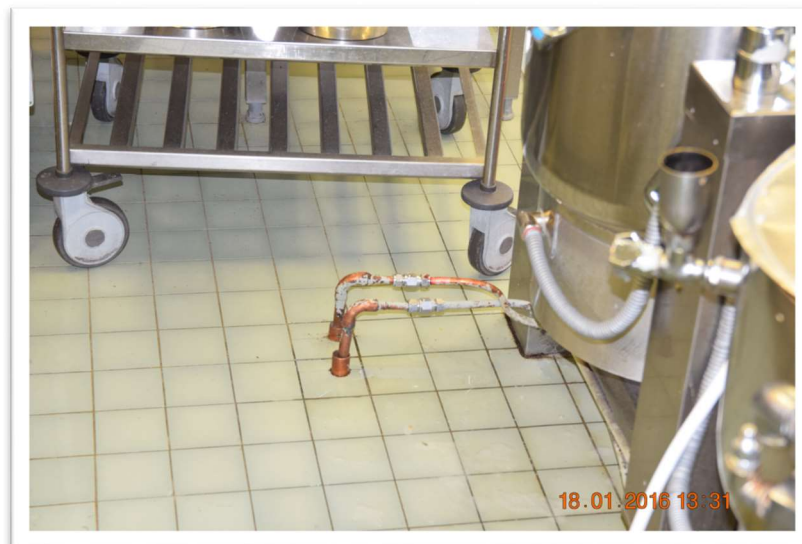
Kuva 53. Vanhassa keittiössä kupariputket tekivät keittiön toimintaa haittaavia sivuttaissiirtoja.
