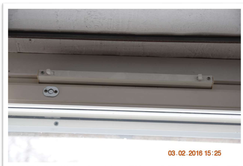
Kuva 32. Iltalan korvausilma tulee pääosin kuvan karmiventtiilien kautta.
