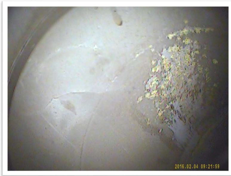
Kuva 26. A-siiven päällä sijaitsevassa sadevesiviemärissä on mahdollinen halkeama.
