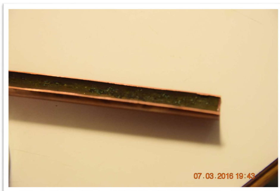
Kuva 10. Keittiötä palvelleet alkuperäiset kupariputket 1960-luvulta, putket on halkaistu sisäpuolelta kulumista selvitettyä.
