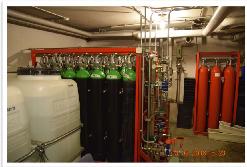
Kuva 4. Marioff Corporation Oy:n sammutusjärjestelmän keskus Iltalassa
