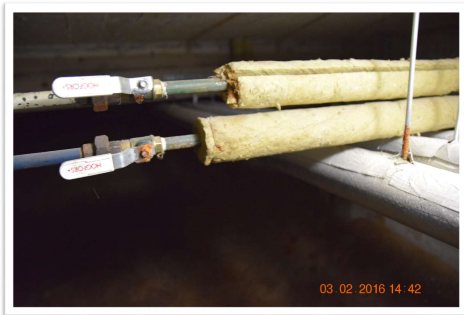
Kuva 28. Alapohjassa sijaitseva lämmityksen venttiili, joka on alkanut vuotamaan.
