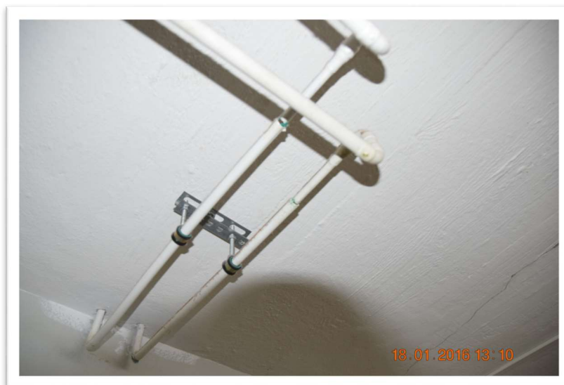
Kuva 14. C-siiven kellarista 1. kerroksen kalusteelle nousevat vesijohdot.
