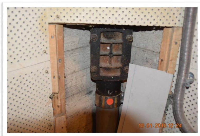
Kuva 21. C-siiven kellarissa oleva vanha viemäri, johon on liitetty uudella muoviviemärillä.
