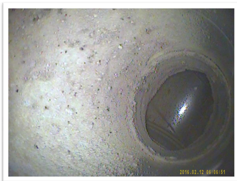
Kuva 42. B-siiven poistoilmakanaviston pölykertymä ylittää P2:n raja-arvon.
