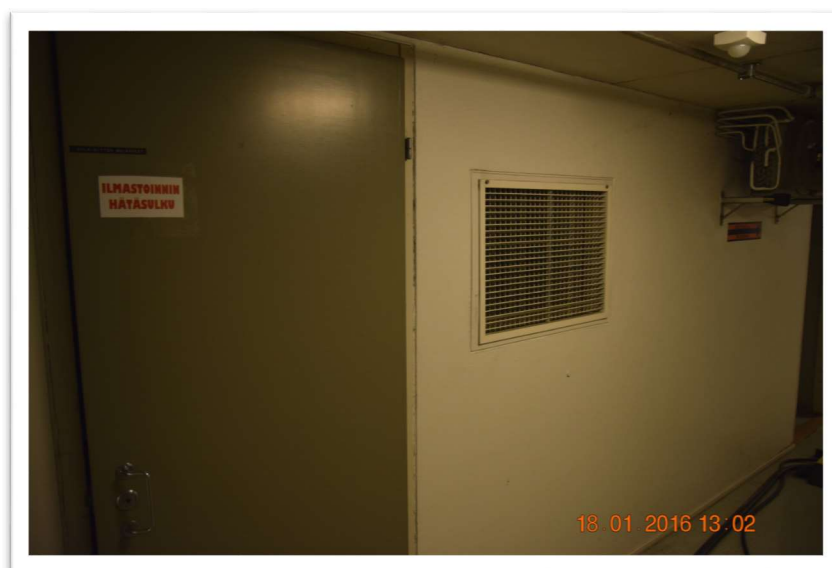
Kuva 35. Kellarin käytävän tuloilma tulee kuvassa olevasta säleiköstä. Sen takana sijaitsee IV-konehuone.
