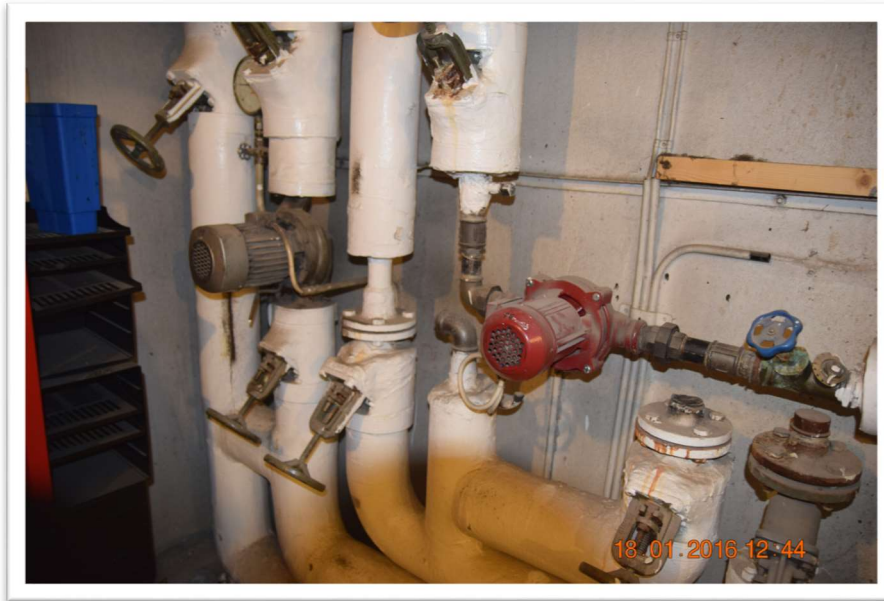
Kuva 29. Kellarissa sijaitseva vanha shunttiryhmä, joka on laitteistoltaan kulunut.
