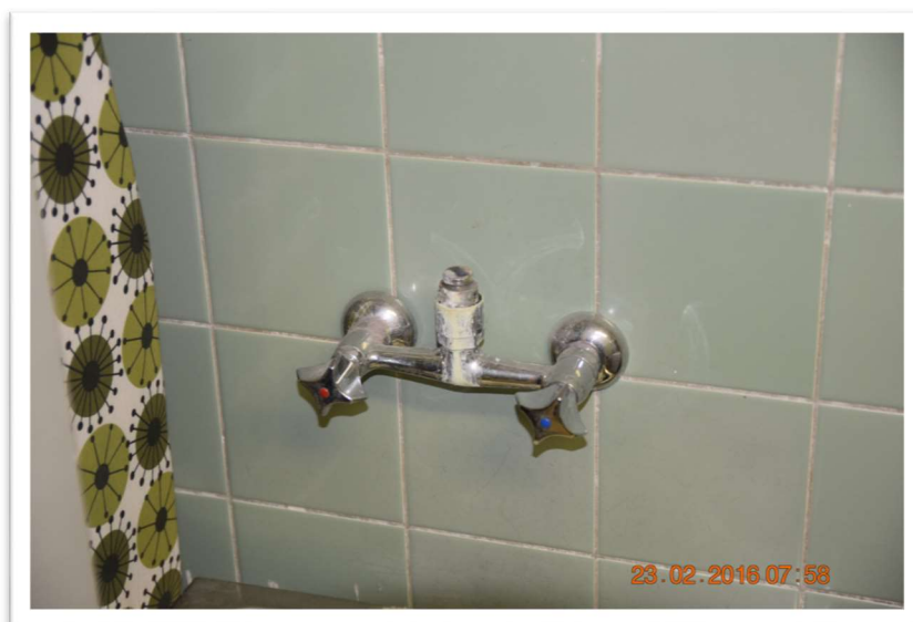
Kuva 15. C-siiven kellarin pesulassa sijaitseva ylimääräinen tulpattu hana, joka on jätetty paineelliseksi.
