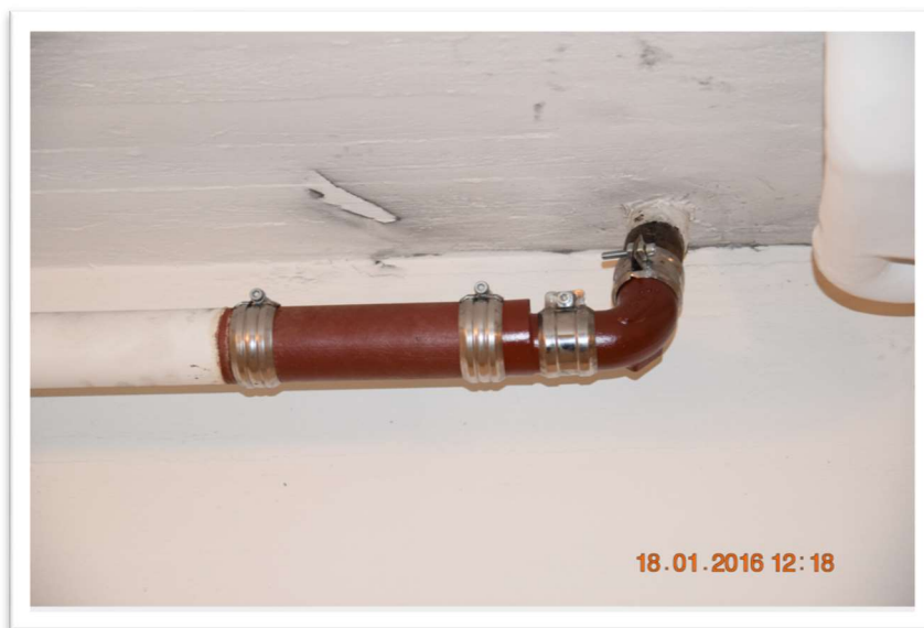
Kuva 3. Osa valurautaisesta viemäristä on jouduttu uusimaan huonon kunnan vuoksi.
