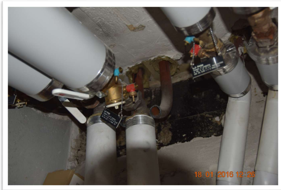
Kuva 27. Lämmityksen uudet runkoveniilit ovat mallia Oras. Taustalla näkyvissä vanhat lämpöjohdot, jotka on jätetty tulppaamatta.
