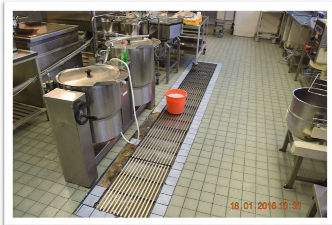
Kuva 52. Vanhan keittiön patojen eteen sijoitettu lattia-allas oli väärin päin toiminnan kannalta.
