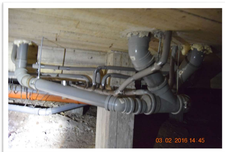
Kuva 20. Useat alapohjan putkiläpivienneistä on heikosti tiivistetty.
