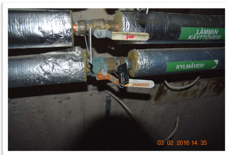
Kuva 13. A- ja B-siiven alapohjassa sijaitseva kylmänveden sulkuventtiili, joka on pahoin syöpynyt.
