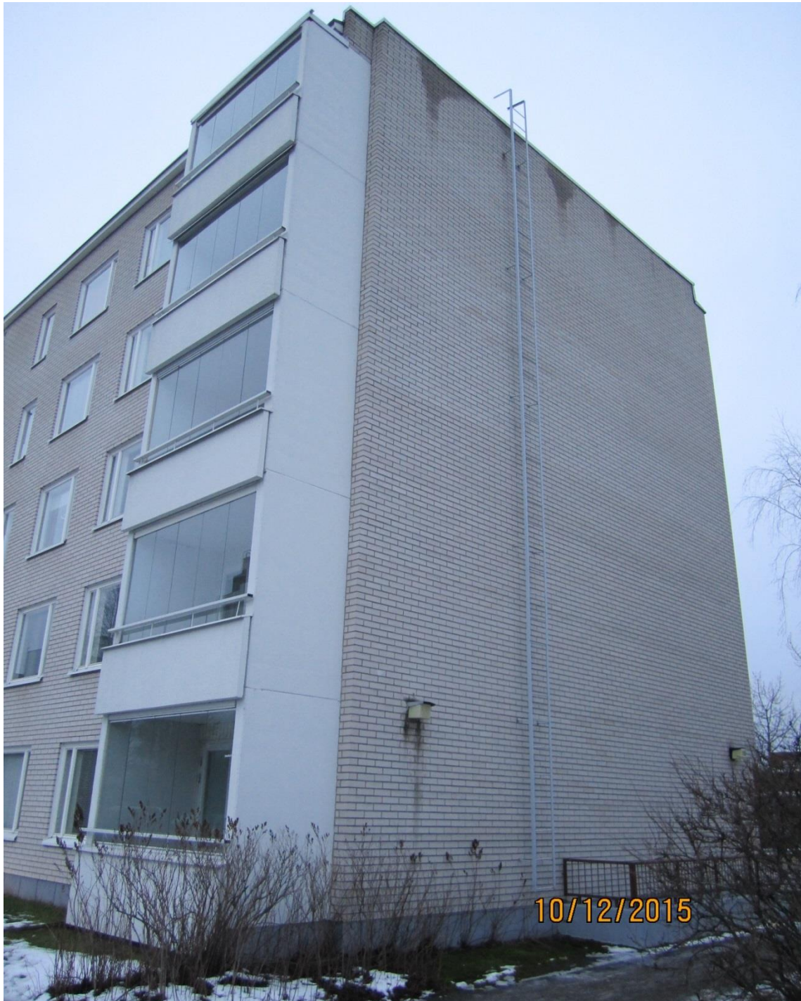
KUVA 2. Vuonna 1974 valmistuneessa asuinkerrostalon julkisivussa näkyy ajan aiheuttamaa kulumaa
