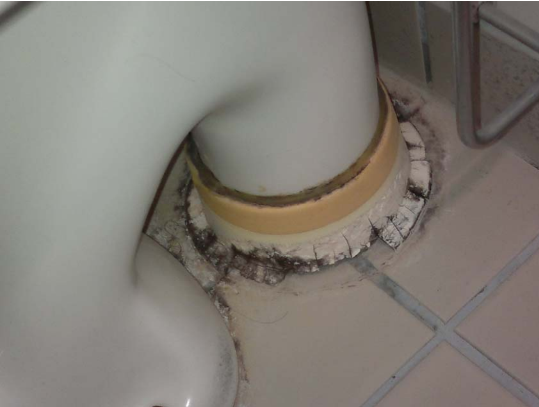
Kuva 11. Remontin yhteydessä, WC-istuinta vaihdettaessa, ei ole huomattu vaihtaa mansettia. Kuva ei ole TAKKin työssäoppijan tekemästä suorituksesta.
