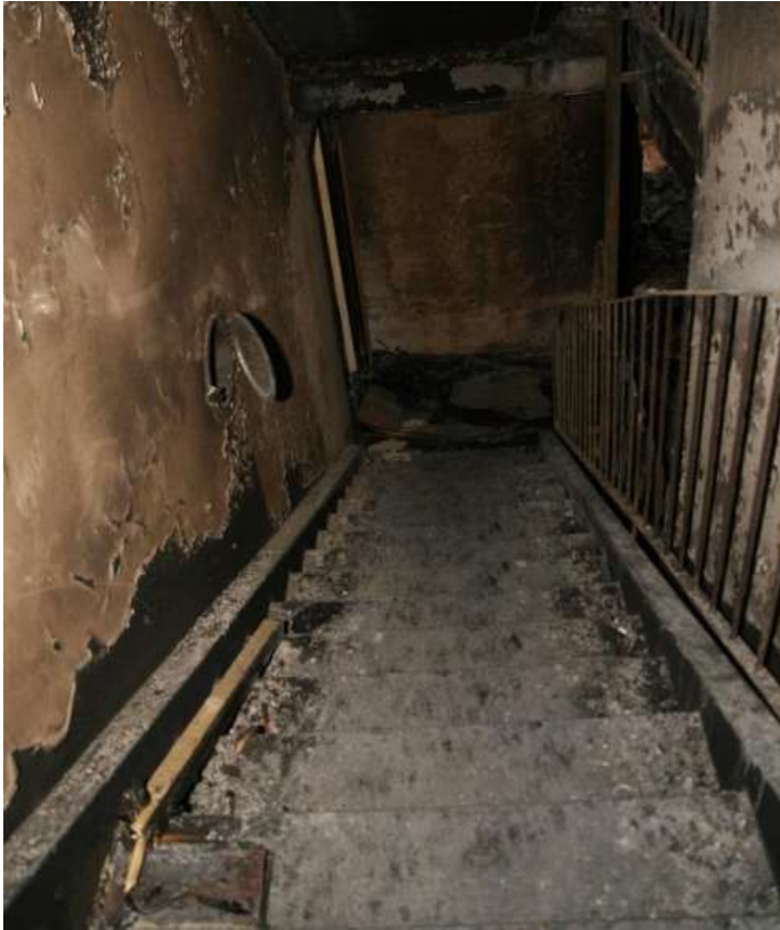
Bild 11. Trapphuset efter branden. Foto: Otkes
