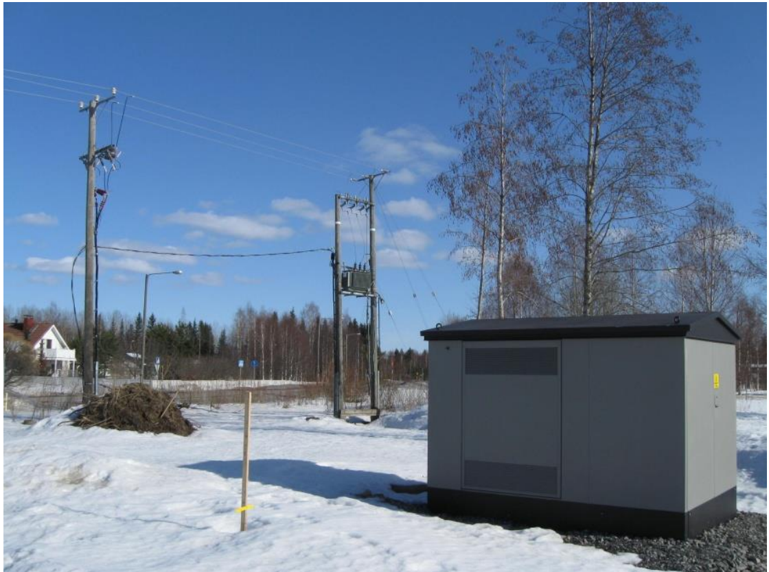
KUVA 3. Puistomuuntamo ja pylväsmuuntamo (Järvinen 2012)
