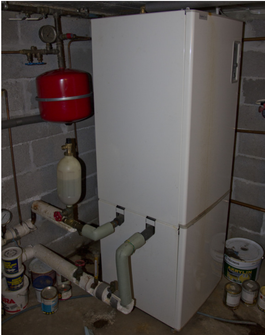
Kuva 3. Esimerkki valmiista pumppuasennuksesta
