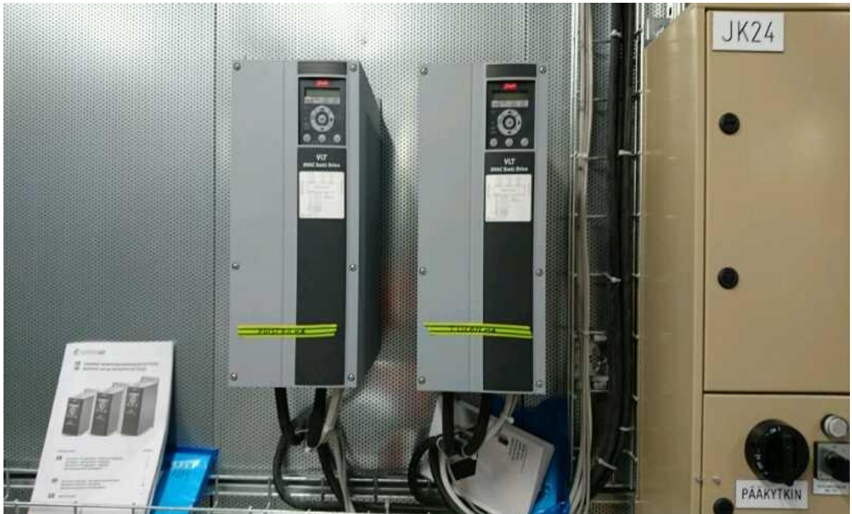
KUVIO 24. IV-koneen tulo- ja poistoilmapuhaltimien taajuusmuuttajat, joita ohjataan taloautomaatiolla.
