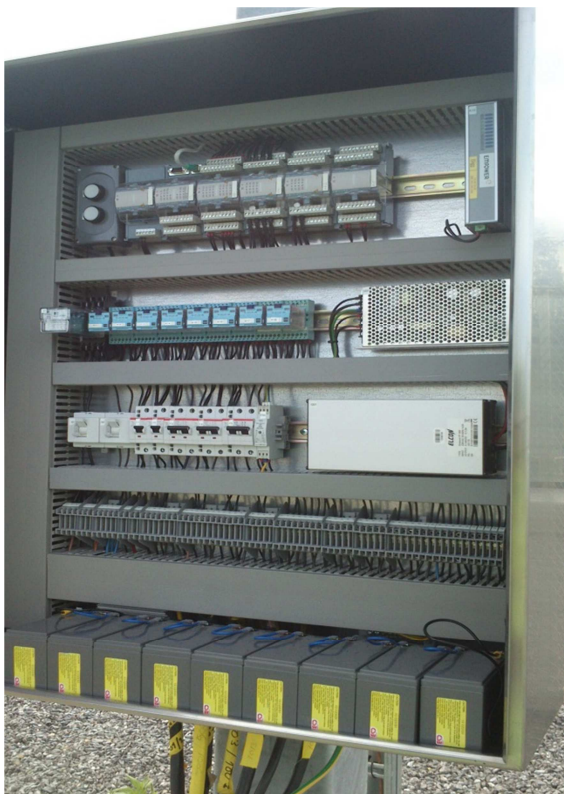
Kuva 6. Erotinaseman kauko-ohjauskaappi (EPV 2015c)
