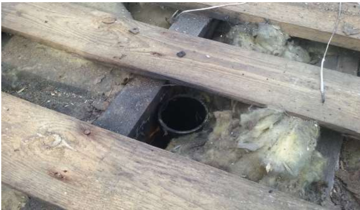
Kuva 11. Yksiön viemärin tuuletusputki.
