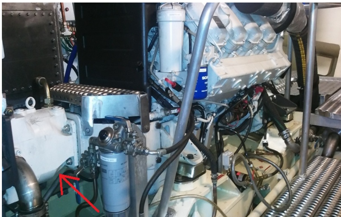
Kuva 3. Kaapeliveneen kansihydrauliikan pumppu ottaa voimansa SB-pääkoneen vapaasta päästä. (Juho Tikka 2015)
