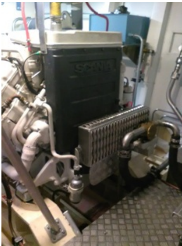
Kuva 27. Vasemman pääkoneen vapaasta päästä ottaa voimansa Jabscon pilssipumppu. (Juho Tikka 2016)
