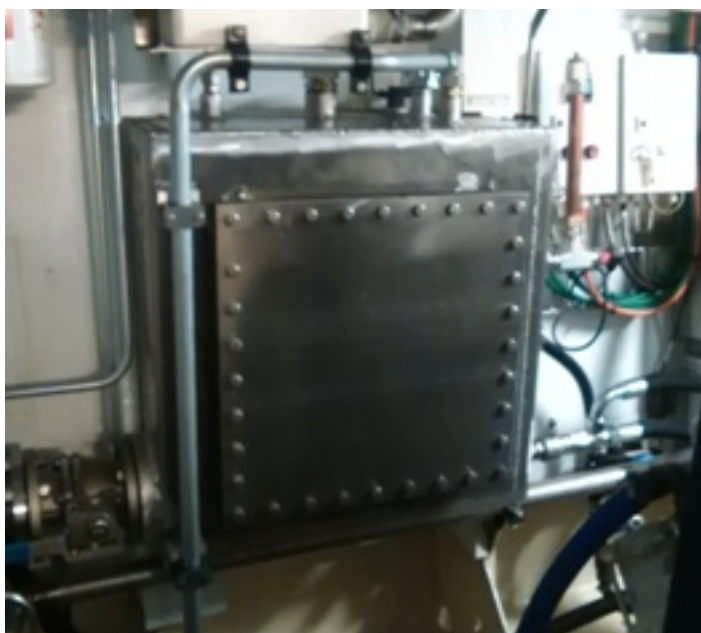
Kuva 13. Kansihydrauliikan hydraulioöljysäiliö. (Juho Tikka 2015)
