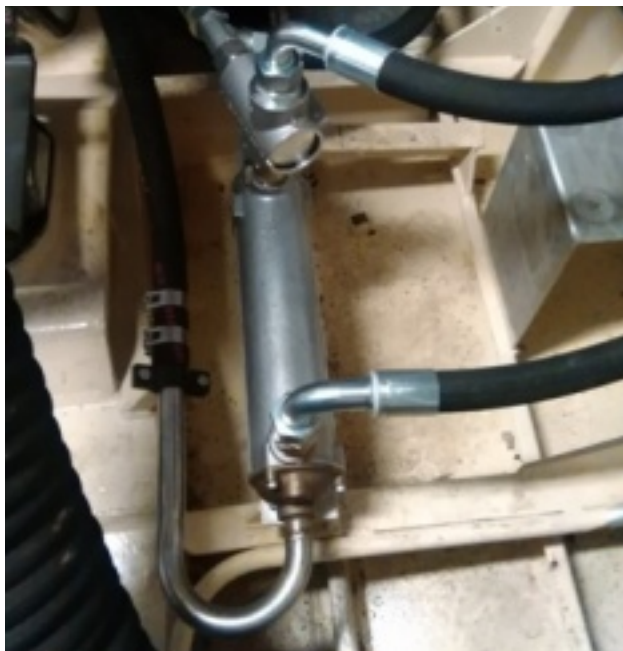
Kuva 12. Kansihydrauliikan lämmönvaihdin ja vahatermostaatti. (Juho Tikka 2015)
