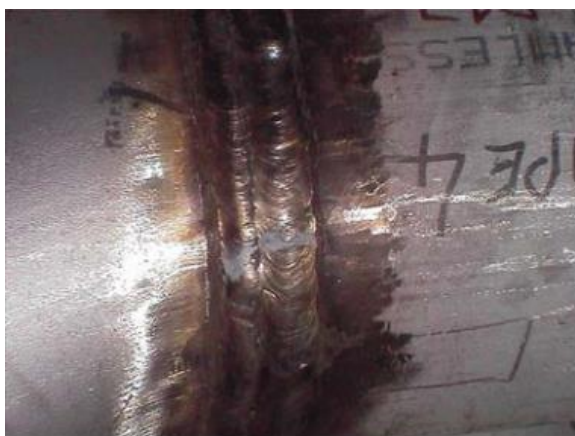
Figur 13 Rostfritt stål i "svetsat tillstånd, svetsoxiden kommer sannolikt att orsaka korrosion angrepp om den inte avlägsnas väl (Crookes. R., 2004, s.8).
