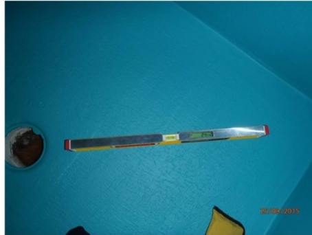
Lattian kallistukset ovat riittävät
