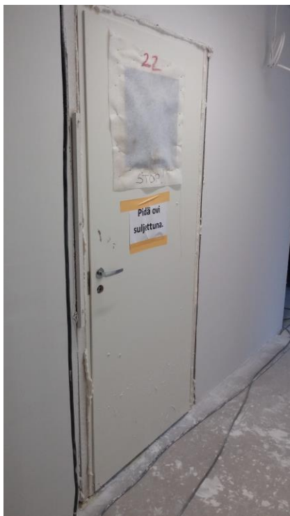
KUVA 2. Osastoiva ovi. (Kuva: Osku Laine 2016.)
