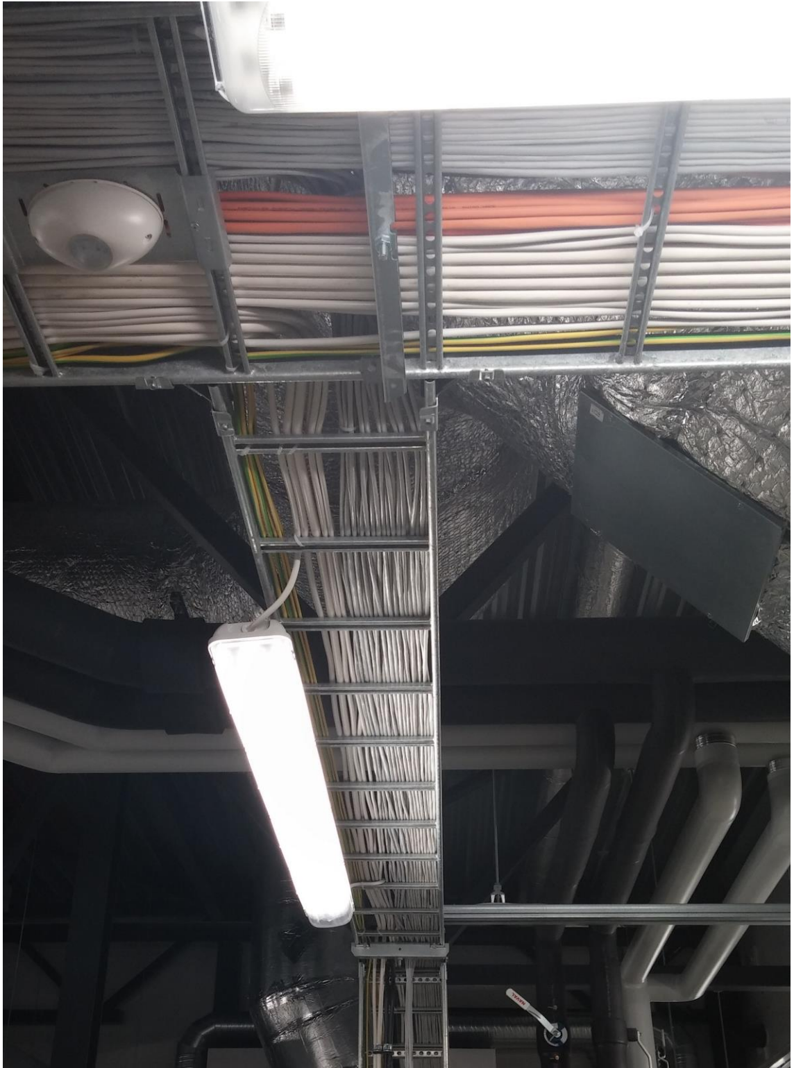
Kuva 13. Yhden ilmastointikoneen kaapelointi perinteisellä tavalla toteutettuna.
