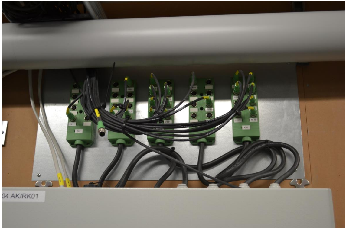
Kuva 8. Pikaliitinrivistö keskuksen yläpuolella.
