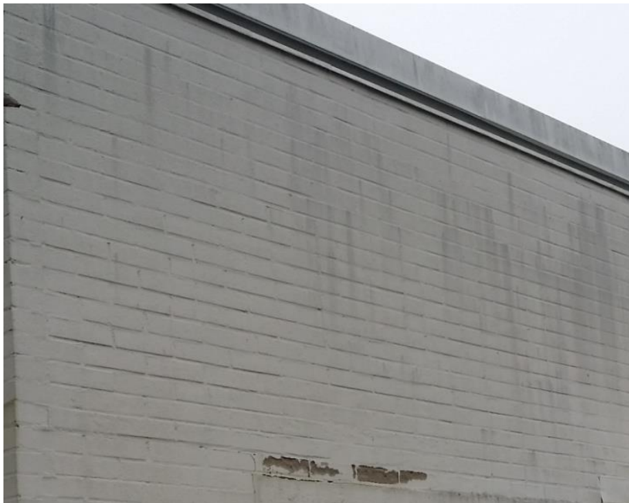
Kuva 11. Julkisivussa paikoin irronnutta rappausta ja pinnan värjäntymistä
