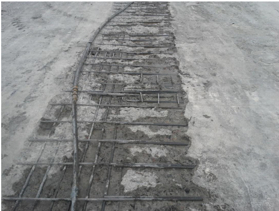
Kuva 8. Vesipiikkauksen ulottuminen sillan raudoituksiin.
