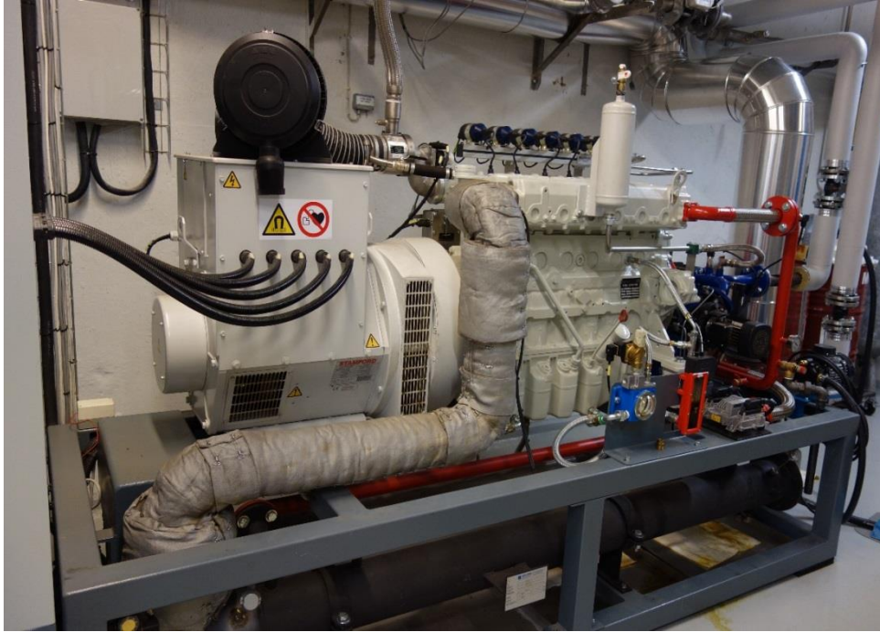
Figur 3 Den relativt nyinstallerade gasmotorn.
