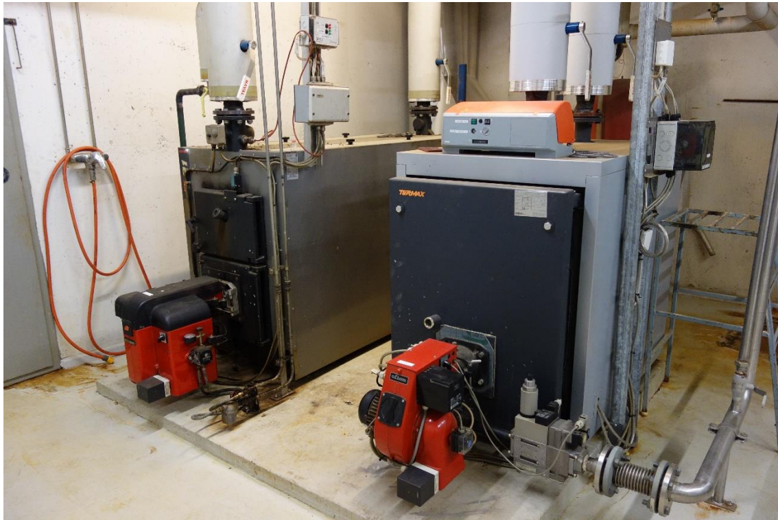
Figur 4 Pannorna som är installerade idag, gaspannan till höger och oljepannan till vänster på bilden.
