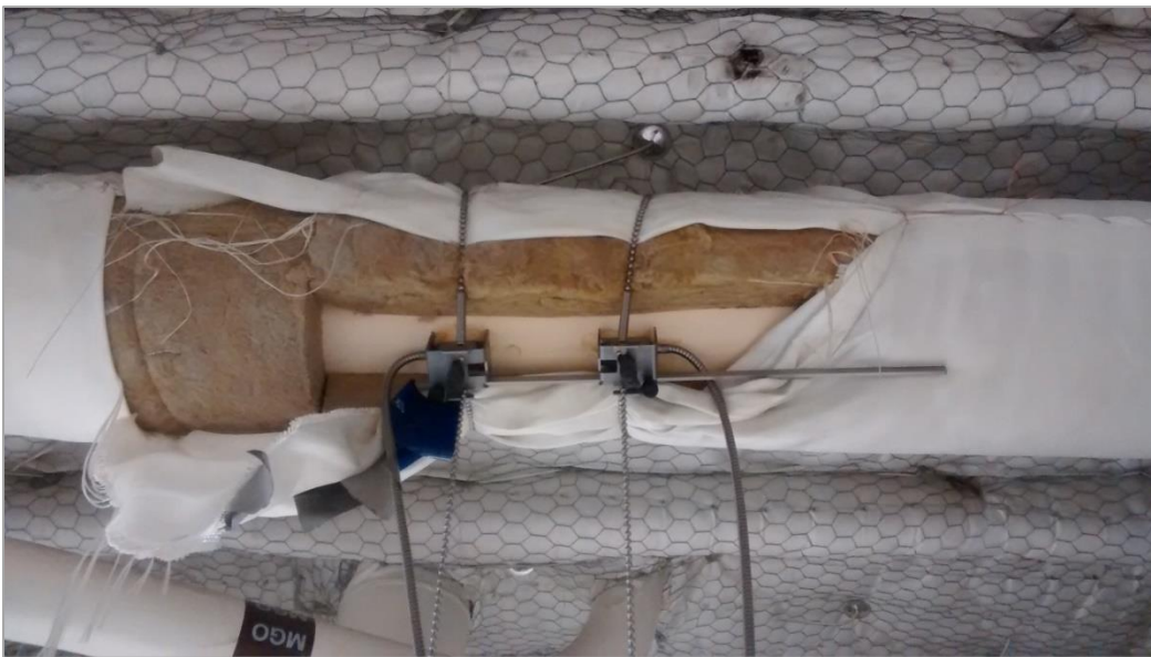
Figur 7: Ultraljudsmätare fäst på röret för att mäta upp flödet till evaporator/tappvatten ledningen \dot{V}_1 .
