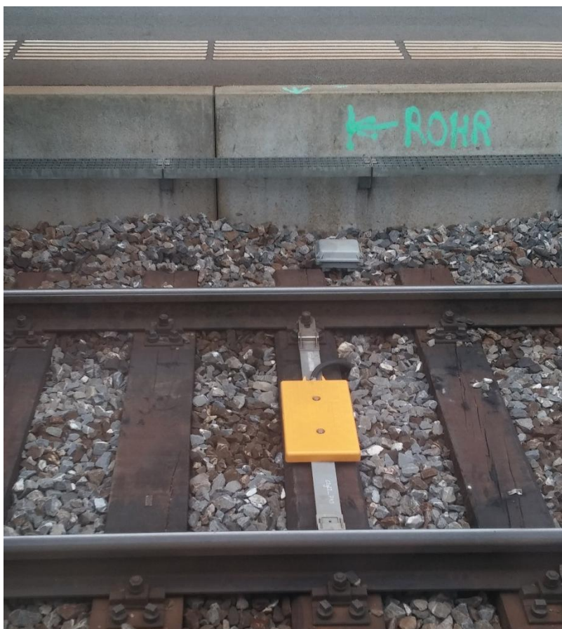
Kuva 7: Sähköistetty baliisi Sveitsissä Luzern-Bern-radalla (Oma kuva)
