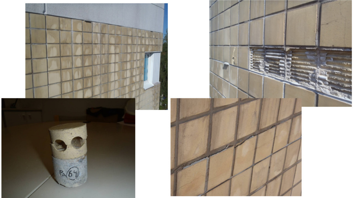
Kuva 22: Peruskuntotutkimuksessa ja lisätutkimuksessa näytteissä ja julkisivuissa havaittuja vaurioita.
