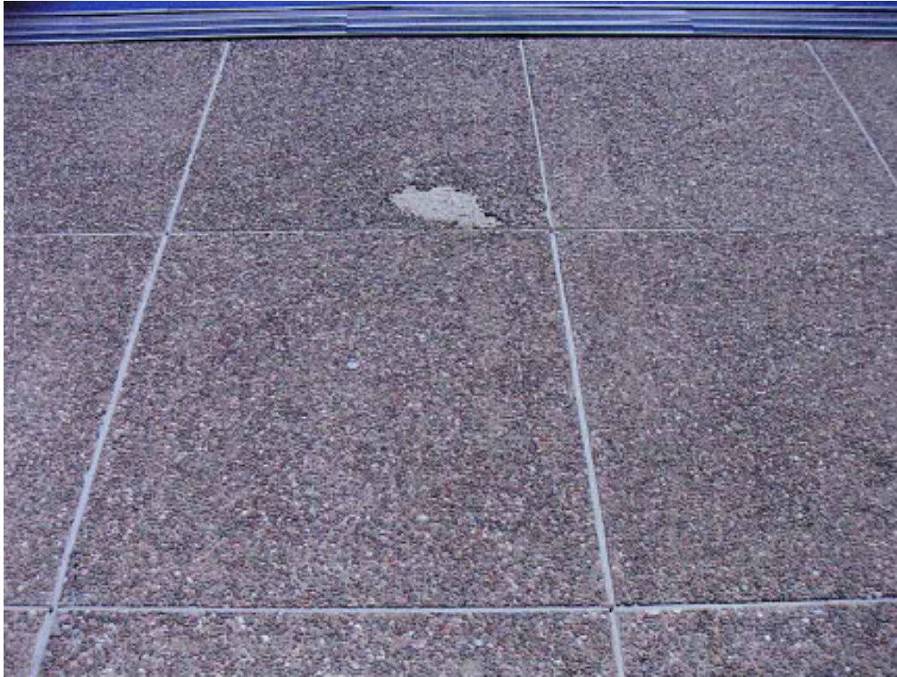
Kuva 17: Kuvassa 10 esitetty elementti vuoden 2006 kuntotutkimuksessa.
