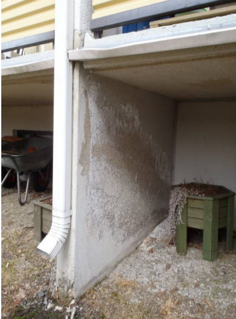
Kuva 19: Parvekkeen maantasokerroksen pieliseinän vaurioita vuoden 2013 kuntotutkimuksissa.
