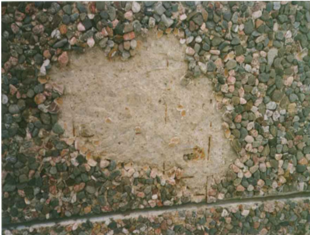
Kuva 16: Vaurioitunut pesubetonielementti vuoden 1998 kuntotutkimuksessa.
