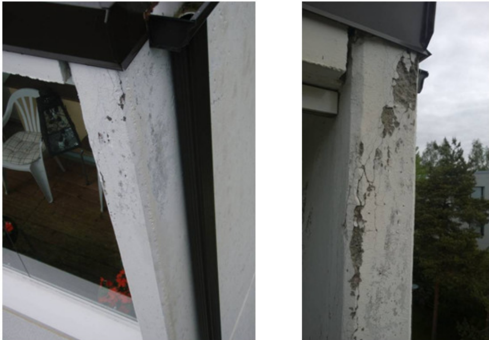
Kuvat 9 ja 10: Vasemmalla talon 1 itäpäädyn ylin pieliseinä vuonna 2008. Oikealla sama pieliseinä vuonna 2014. Pakkasrapautuminen on edennyt pieliseinän etupinnassa, lisäten betonin halkeilua ja irtoilua.
