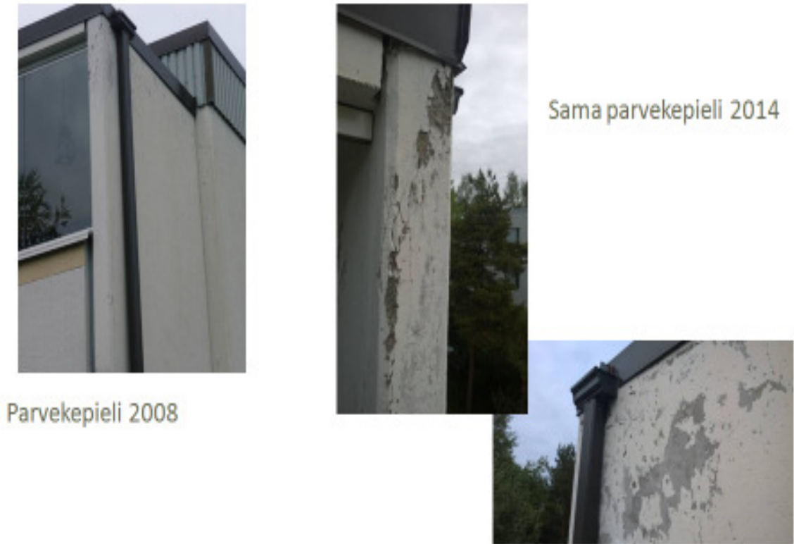
Kuva 3: Parvekepieliseinän vaurioitumisen eteneminen kuntotutkimuksien välillä (Ranki;ym., 2015).
