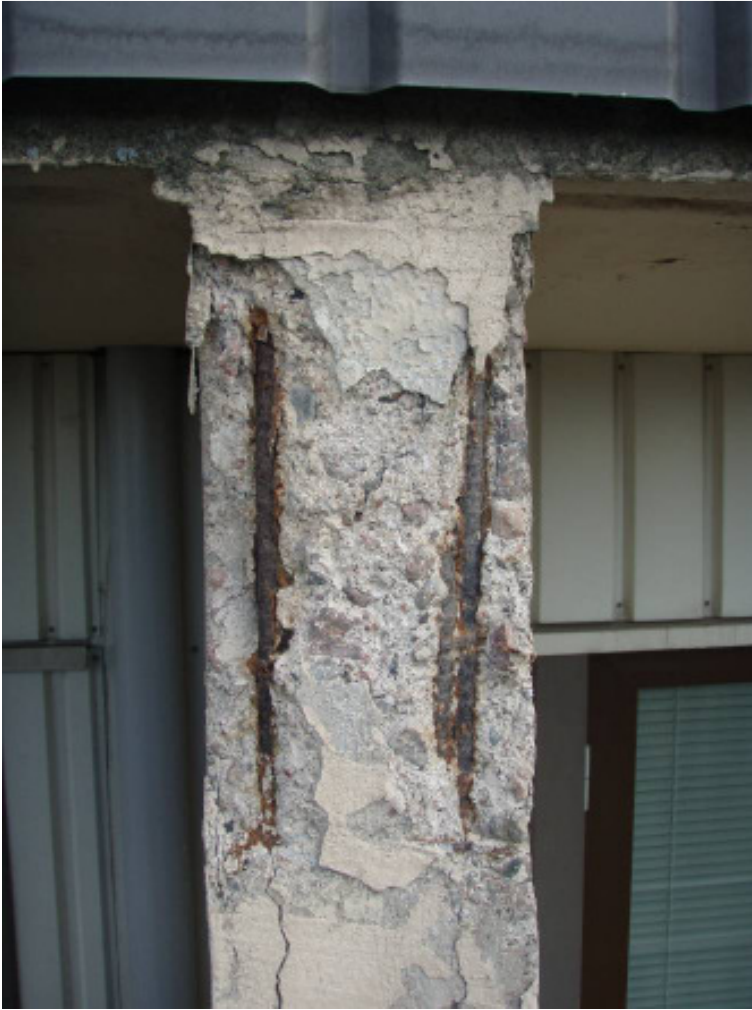
Kuva 24: Perustutkimuksessa pieliseinissä havaittuja vaurioita.
