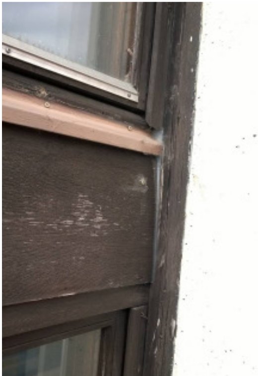
Kuva 11: Porrashuoneen kohdan vanerilevyjen vaurioita vuoden 2014 kuntotutkimuksessa.
