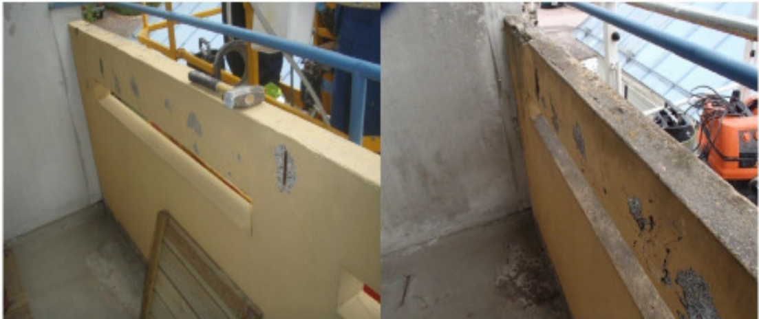
Kuva 11: Vasemmalla [redacted] itäisivun alimman parvekkeen kaide vuonna 2007. Oikealla sama parvekekaide vuonna 2015. Teräskorroosioauriot ovat lohkaisseet paloja betonista. Pintarapautuma- ja maallipinnoiteauriot ovat laajentuneet. Kaiteen vaakapinnoille on tullut levä-/jäkäläkäsivustoa. Parvekelaatan pinnoiteaurion kohdalta on ruostunut teräs esliin.
