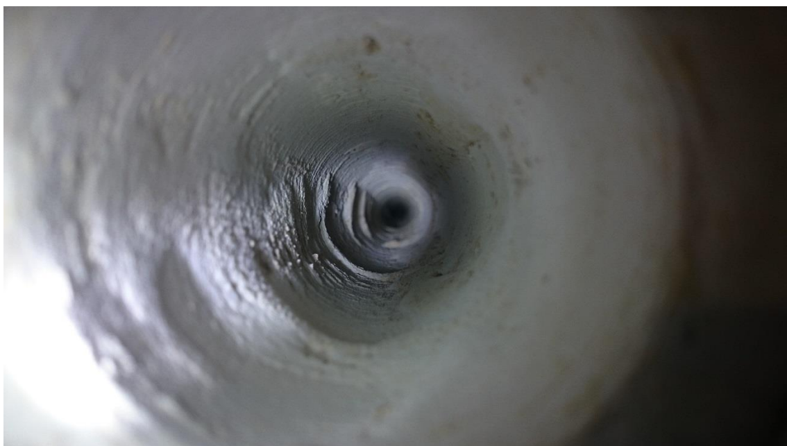
KUVA 3 Tuliputki noin kuukausi edellisestä nuohouksesta (Valokuva Joonas Lehto.)
