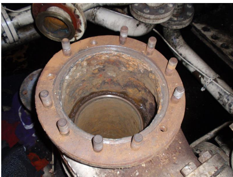
Kuva 11. Merivesikaivon venttiili. (Jan-Kristian Lindroos 2015)
