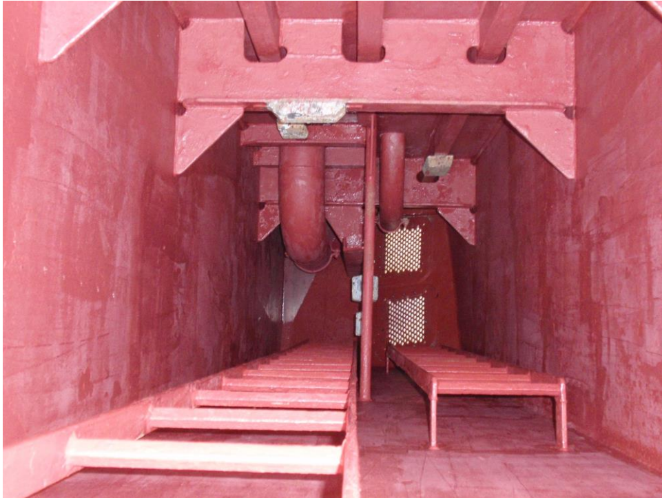
Kuva 24. Keulimmainen merivesikaivo huollettuna ylhäältä kuvattuna. (Jan-Kristian Lindroos 2015)
