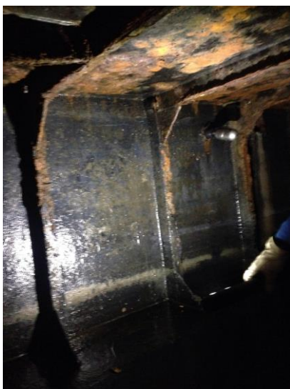
Kuva 2. Likavesitankin syöpynyt katto.
