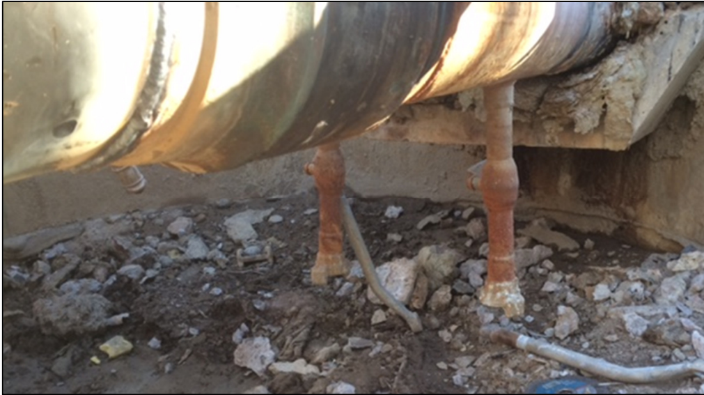
Figur 17: Tömningsventilerna lidit av korrosion och byts före läckage.
