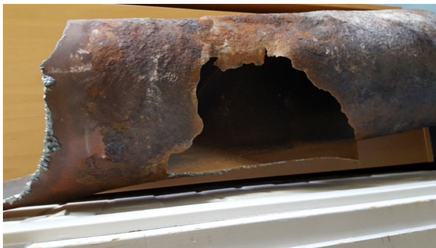
Figur 1: Ett läckage orsakat av korrosion, skedde i Otnäs, Esbo 1.11.2011.
