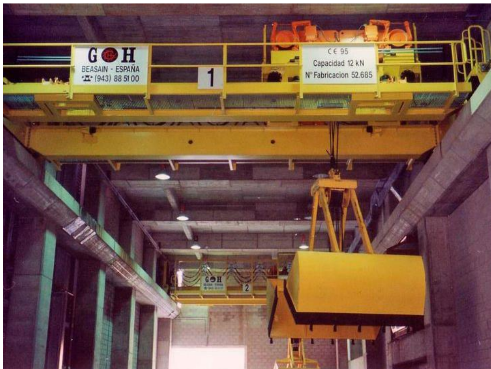
Kuva 1. Kauhalla varustettu siltanosturi (1)
