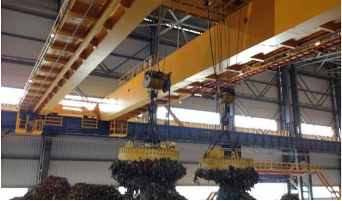
Kuva 5. Sähkömagneeteilla varustettu siltanosturi (11)
