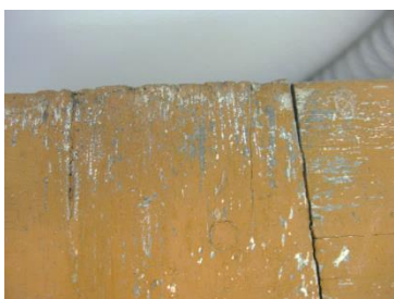
Kuva 46. Alta näkyviä maalikerroksia.
