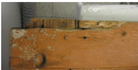
Kuva 72. Ison oven oikean yläkulman vaurio edestä.
