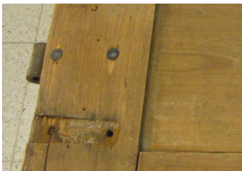
Kuva 40. Yläpuolella nykyinen sarana ovien etupuolella ja alhaalla vanhan saranan paikka.
