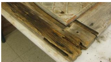
Kuva 51. Kuvan puuosassa on pinnassa halkeamia ja siitä puuttuu paloja.
