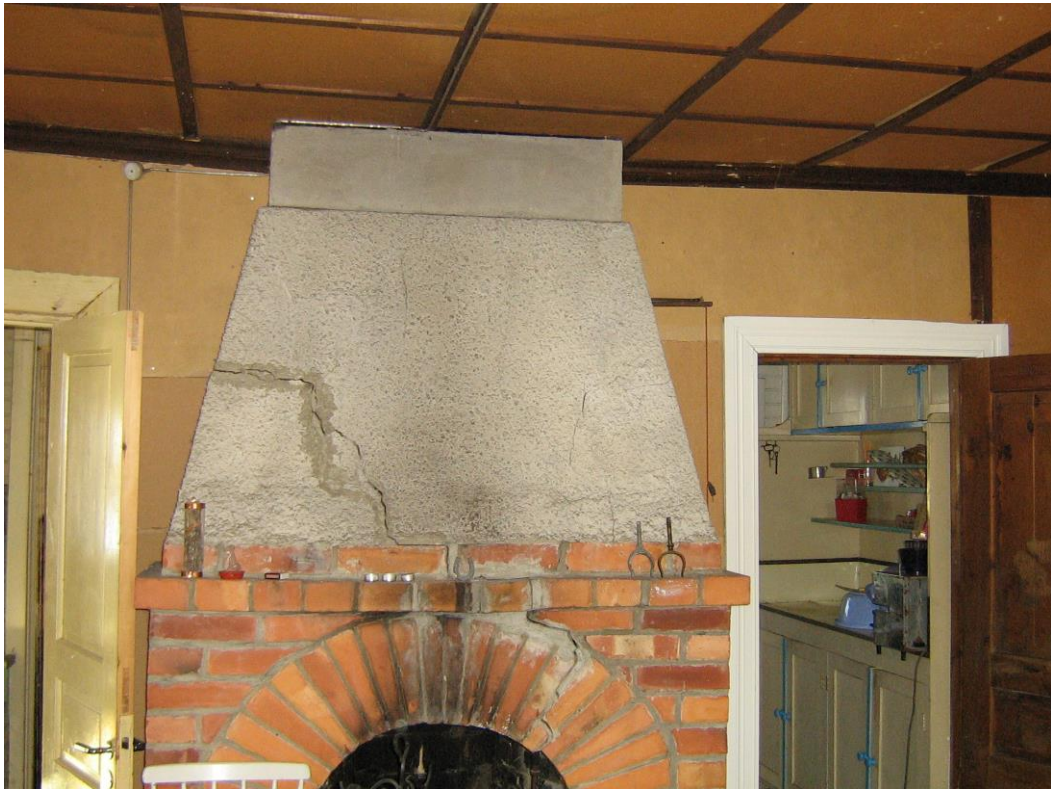
Kuva 6. Tulisijassa näkyviä halkeamia.
