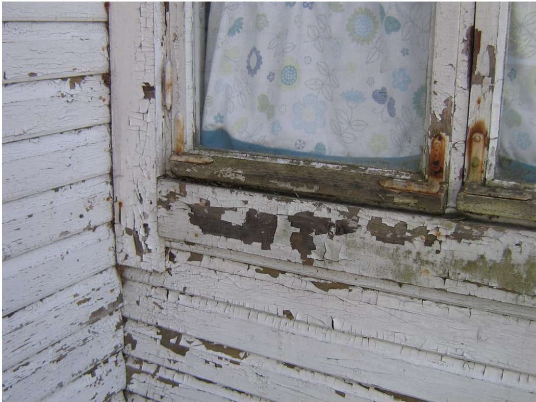
Kuva 8. Ikkunoiden karmit ovat huonossa kunnossa.
