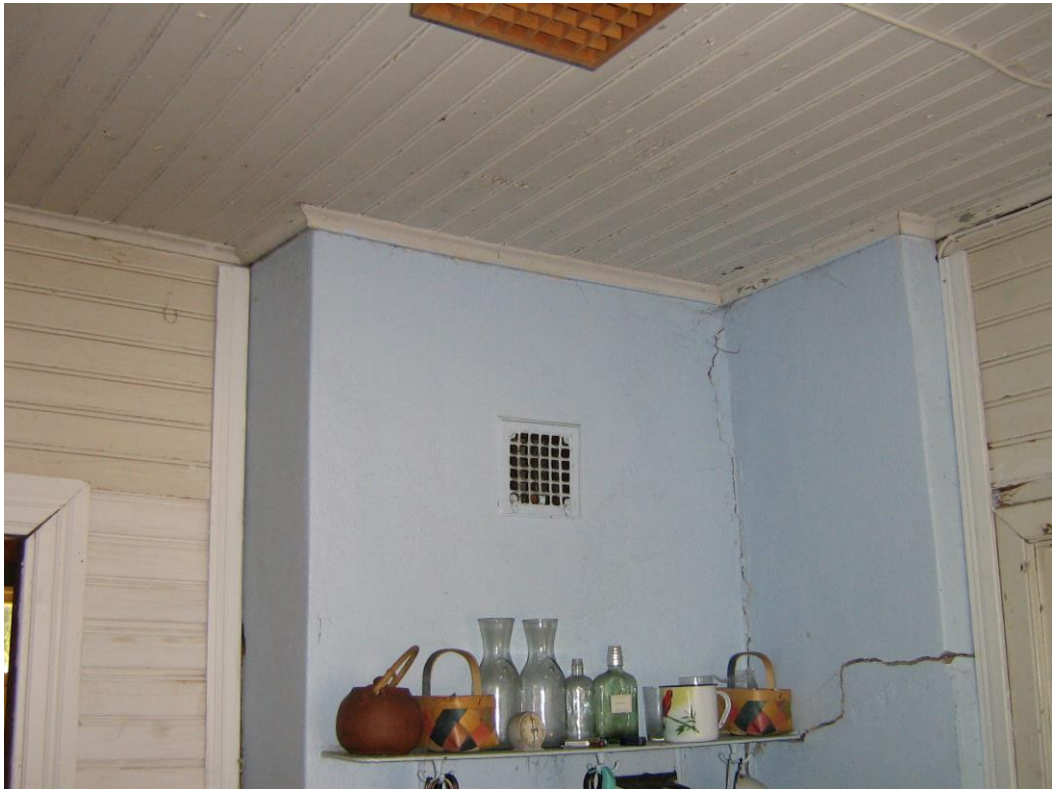
Kuva 10. Savuhormin halkeamat keittiön puolelta.
