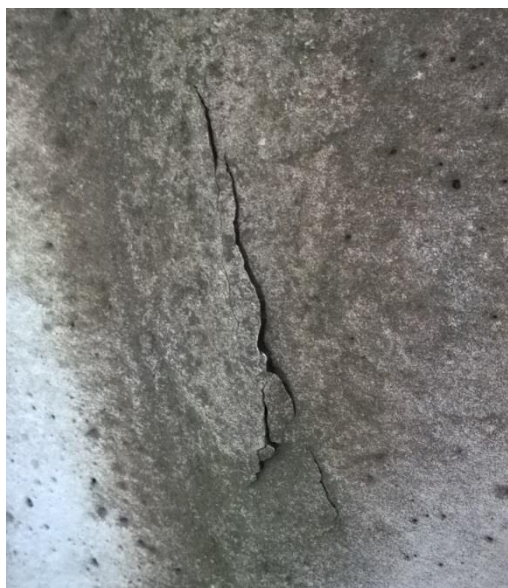
Figur 2. Exempel på avskalning på balkongelement.
