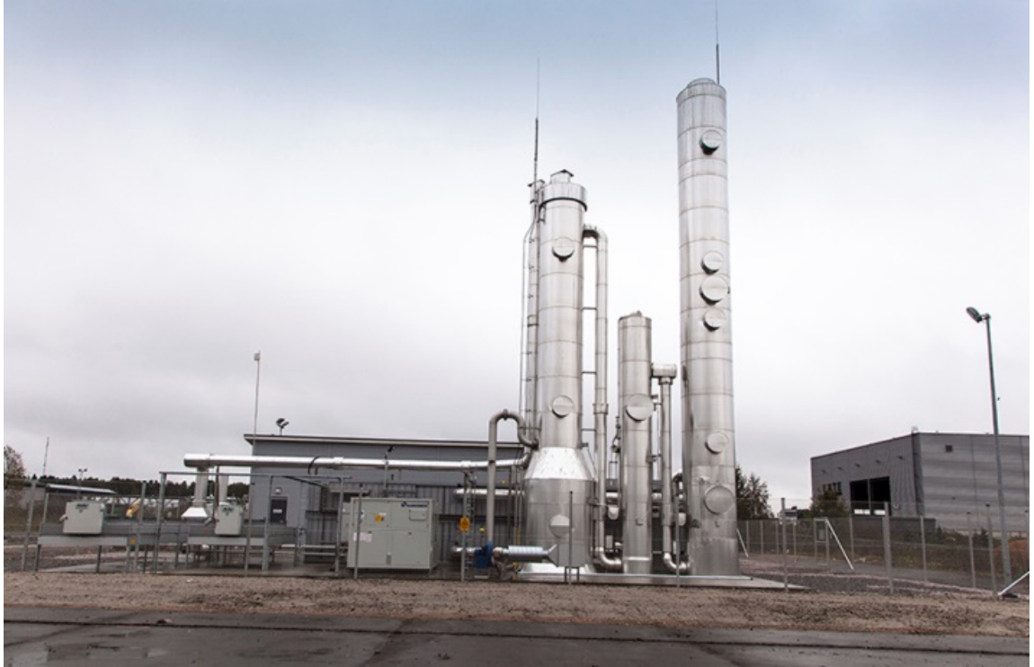
Kuva 1. LABION biokaasulaitos Lahdessa
