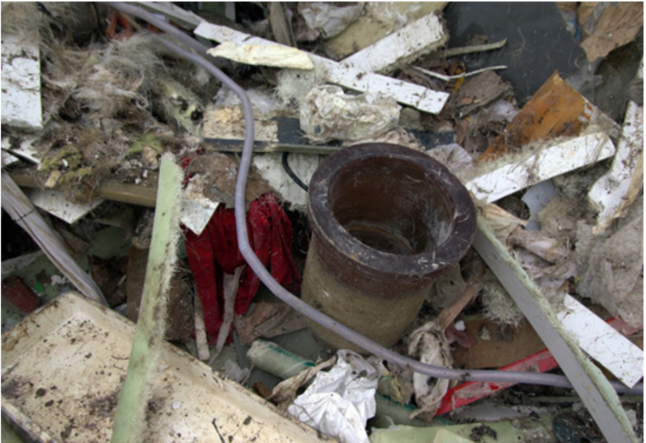
Kuva 18. Käytöstä poistettu putkikaulus. Näiden mukana voi tulla myös metalliosia, esimerkiksi teräksisiä irtolappoja (Kuva Mamk)
