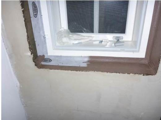
Kuva 3. Vedeneristettä siveltiin vahvistusnauhan päälle vain 50 % ikkunaliittymästä.
