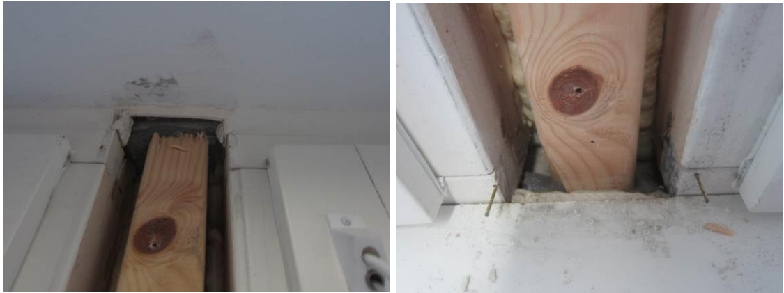
Kuva 15. Ikkunaliittymiä 2000-luvulla valmistuneessa kohteessa. Ikkunan yläreunan ja välipohjarakenteen välinen liittymä on tiivistetty joustavalla saumausmassalla pohjanauhaa käyttäen. Ikkunavälin peitelistan irrottamisen jälkeen havaittiin, että polyuretaanivaahdotus on asennettu vain noin 1/3 syvyydelle karmin paksuuteen nähden ja liittymästä on runsaasti ilmayhteyksiä ulkoseinärakenteen lämmöneristekerrokseen. (Kuva: Marja Laitinen, Vahanen Rakennusfysiikka Oy.)
