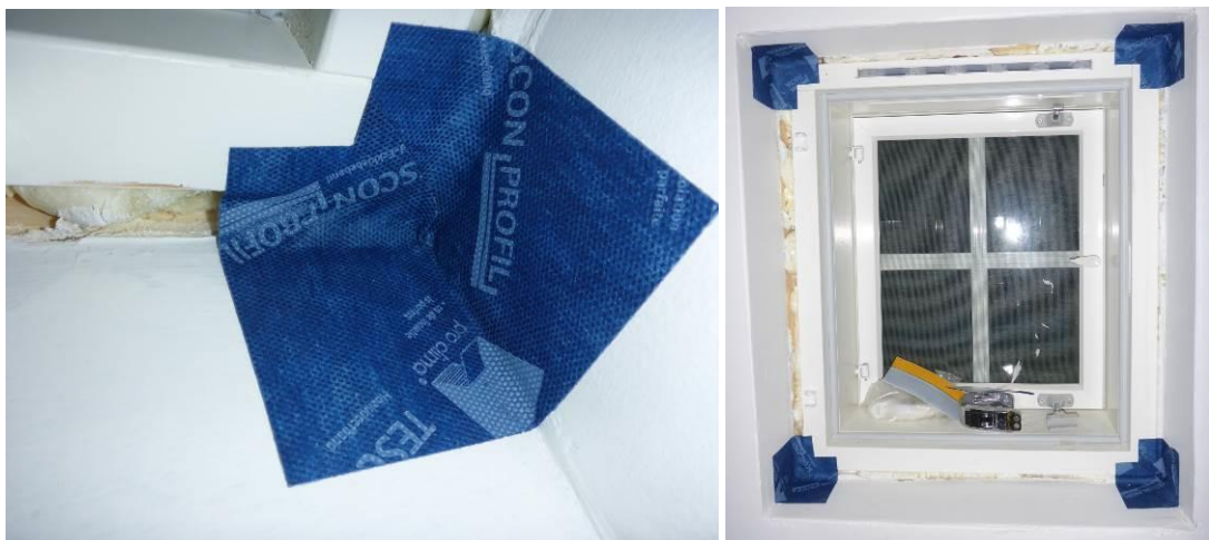
Kuvat 2 ja 3. Ikkunan nurkkaliitokset toteutettiin asentamalla nurkkakohtiin erilliset, muotoillut Tescon Incav –nurkkakappaleet.
