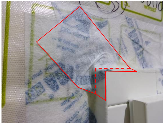
Kuvat 4. Ikkunan yläreunan nurkkaliitoksien päälle asennettiin lisäksi nurkkakohdan kokonaan peittävä liitosnauhakaista. Asennetun liitosnauhan ääriviivat on merkitty kuvaan punaisella viivalla ja liitosnauhan taitos punaisella katkoviivalla.
