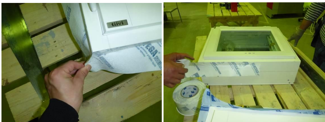
Kuvat 2 ja 3. Liitosnauhan asennus toteutettiin ensin ikkunan karmin sivupintaan, koko karmin ympäri ennen ikkunan asennusta. Ikkunan kulmiin tehtiin nauhalla noin 30-40mm:n taitos liitosnauhan liepeen nurkka-asennusta varten.
