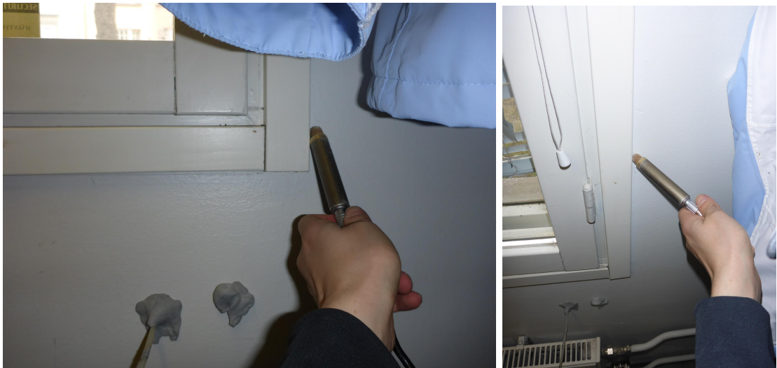
Kuva 13. Merkkiainekoe kuvassa 12 esitettyyn ulkoseinärakenteeseen. Merkkiainekokeessa havaittiin ilmapuotoja lämmöneristekerroksesta huonetilaan kaikissa tutkituissa ikkunaliittymissä. Merkkiainekoe toteutettiin rakennuksen normaalissa käyttötilassa, ilman huonetilan alipaineistusta. (Kuva: Mikko Koskivuori, Vahanen Rakennusfysiikka Oy.)
