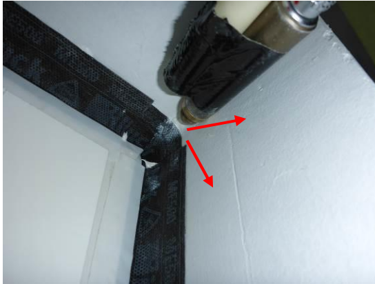
Kuva 11. Vuotoja havaittiin myös yhdessä nurkassa, jossa aistinvaraisessa tarkastelussa havaittiin reikä nurkkakappaleen ja ikkunapielen nurkkaan asennetussa massauksessa. Vuoto oli voimakkuudeltaan vähäinen
