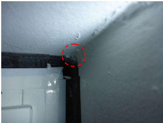
Kuva 8. Yhdessä ikkunapielen nurkassa havaittiin nurkkakappaleen alle asennetussa saumaussmassauksessa reikä.
