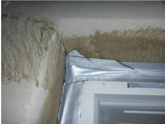
Kuva 3. Osaan nurkkakohdista, joissa ikkunapielen nurkka oli epätasaisempi asennettiin limityksen päälle koko limityksen peittävä liitosnauhakappale
