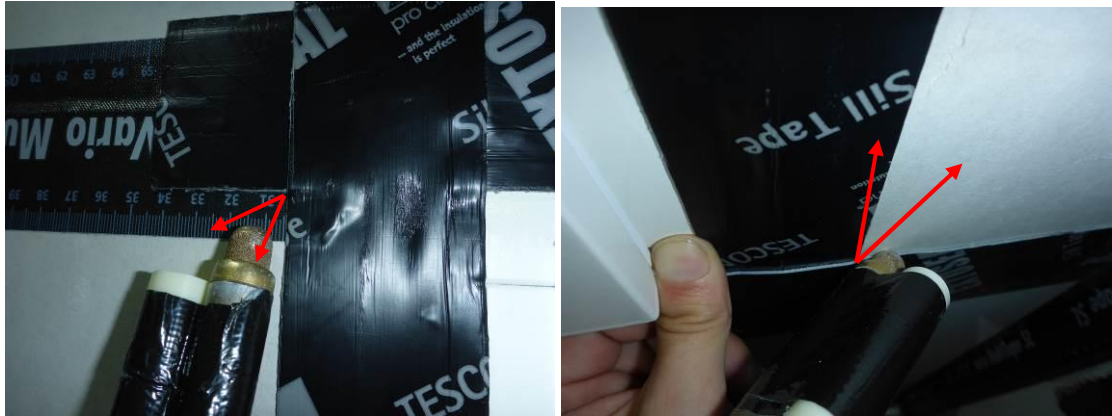
Kuvat 7 ja 8. Nurkassa limittyvien liitosnauhojen saumakohtaan jää ilmayhteys liittymän läpi, josta voitiin havaita vähäistä vuotoa.
