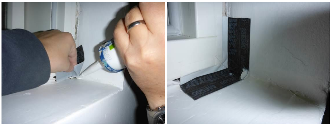
Kuvat 4 ja 5. Nurkkakappaleiden alle, ikkunapielen nurkkaan asennettiin SP 525 – tiivistysmassa ennen nurkkakappaleen kiinnittämistä ikkunapielen pintaan.
