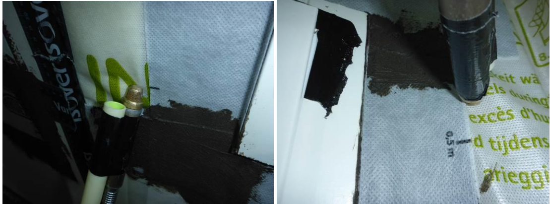
Kuvat 7 ja 8. Merkkiainelaitteella havaittiin paikallisia vähäisiä vuotoja kahdesta koh- taa saumoista, joissa nauhat limittyvät toistensa päälle.
