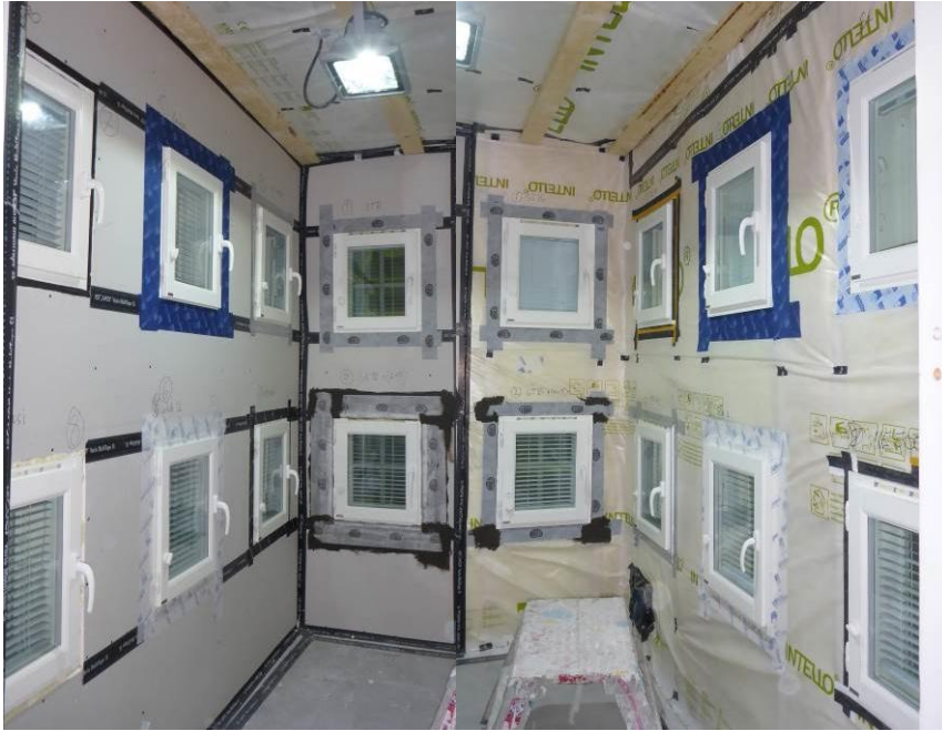
Kuva 35. Yleiskuva testirakennuksen sisältä. Kuvassa on ikkunaliittymille tehdyt asennukset ja seinäpintojen puolittainen sisäverhouslevytyt vasemmalla.
