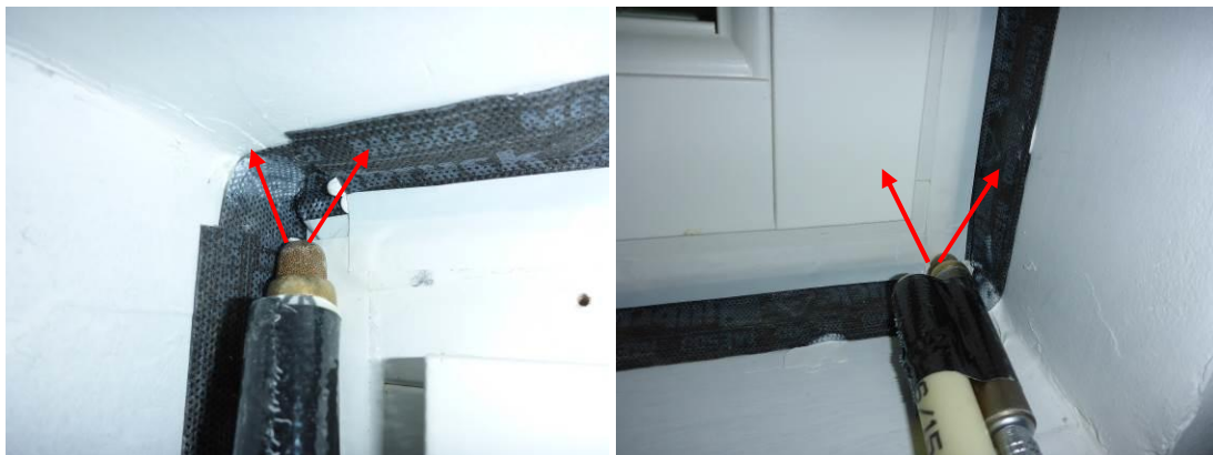
Kuvat 9 ja 10. Merkkiainelaitteella havaittiin ilmavuotoja kahdesta nurkasta, kohdista, joissa liitosnauhan liimapintojen välinen alue oli tiivistetty SP 525 -tiivistysmassalla. Tiivistysmassa ei todennäköisesti ollut täyttänyt liimapintojen välistä aluetta kauttaaltaan. Vuodot olivat voimakkuudeltaan vähäisiä.
