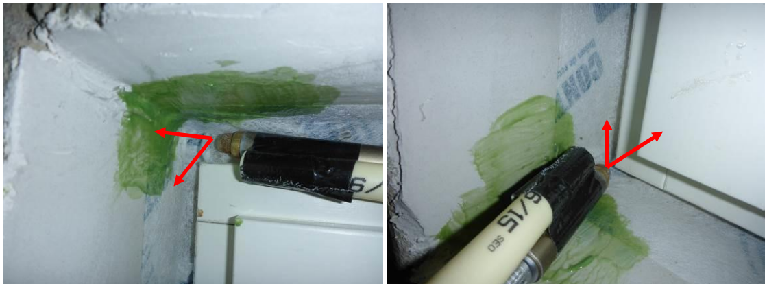
Kuvat 11 ja 12. Suoritetussa merkkiainekokeessa havaittiin vähäistä ilmapuotoa kahdessa nurkkakohdassa, liitosnauhan nurkkataitosten läheisyydessä.
