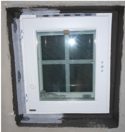
Kuva 1. Ikkunaliittymän tiivistys harkkorakenteisen seinän ikkuna-aukon pielten pintaan toteutettuna Ardex 8+9 –vedeneristeellä ja STB 75-15 –karminauhalla.
