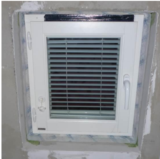
Kuva 1. Ikkunaliittymän tiivistys harkkorakenteisen seinän ikkuna-aukon pielten pintaan toteutettuna Contega Solido SL –liitosnauhalla ja Wyflexa –tiivistysmassalla.
