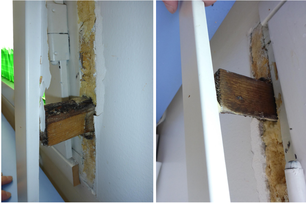
Kuva 12. 1980-luvulla rakennetun kohteen ikkunaliittymien tiivistys. Ikkunarakenne on asennettu samaan tasoon sisäpuolisen betonipinnan kanssa ja karmin ja ulkoseinärakenteen välinen liittymä on täytetty polyuretaanivaahdolla. Vaahdotus on leikattu ulkoseinän sisäpuolelle tasaan. Ikkunan asennuskiilat on jätetty rakenteeseen ja liittymän peitelistä on naulattu niihin kiinni. Asennuskiiloissa on havaittavissa kastumisesta johtuvaa tummentumaa. (Kuva: Mikko Koskivuori, Vahanen Rakennusfysiikka Oy.)
