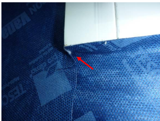
Kuva 7. Ikkunan nurkkaliitoksissa havaittiin liitosnauhan auenneen nurkan yli taitetuista kohdista.
