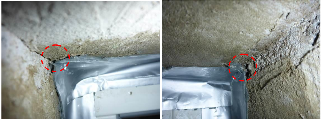
Kuvat 7 ja 8. Kahdessa ikkunapielen nurkassa havaittiin reikä liitosnauhan ja nurkan välissä, kohdissa, joissa ikkunapielenpinta oli epätasainen.
