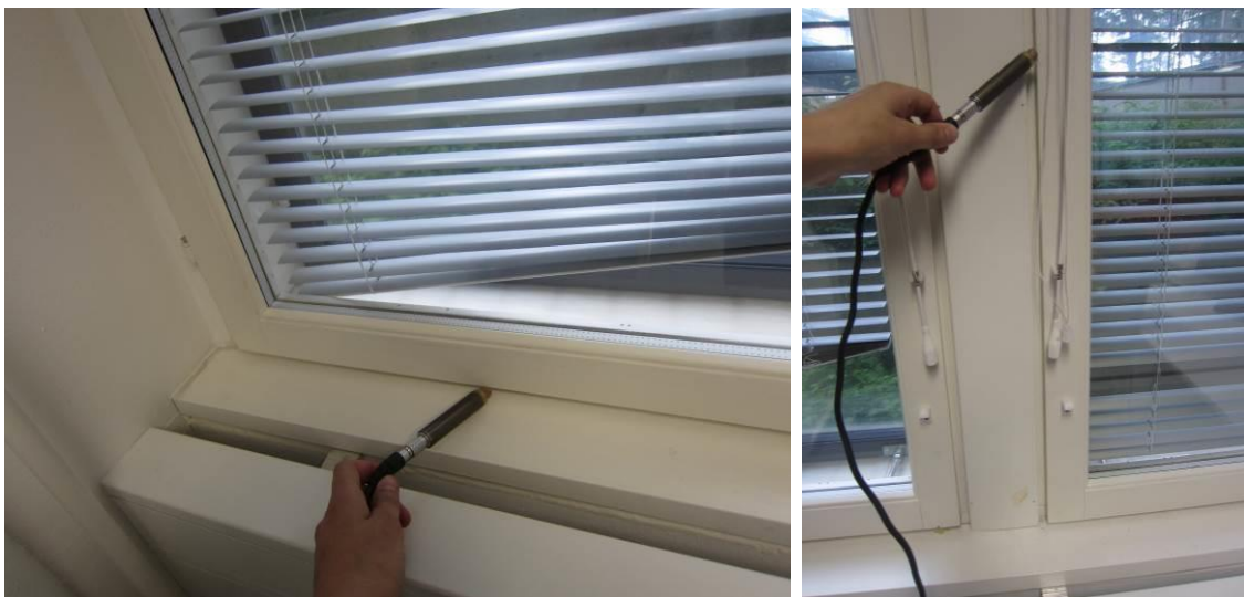
Kuva 16. Merkkiainekoe kuvassa 15 esitettyyn ulkoseinärakenteeseen. Merkkiainekokeessa havaittiin ilmapuotoja lämmöneristekerroksesta huonetilaan kaikissa tutkituissa ikkunaliittymissä, joissa tiivistystä ei ole toteutettu joustavalla saumausmassalla. Merkkiainekoe toteutettiin rakennuksen normaalissa käyttötilassa, ilman huonetilan alipaineistusta. (Kuva: Marja Laitinen, Vahanen Rakennusfysiikka Oy.)
