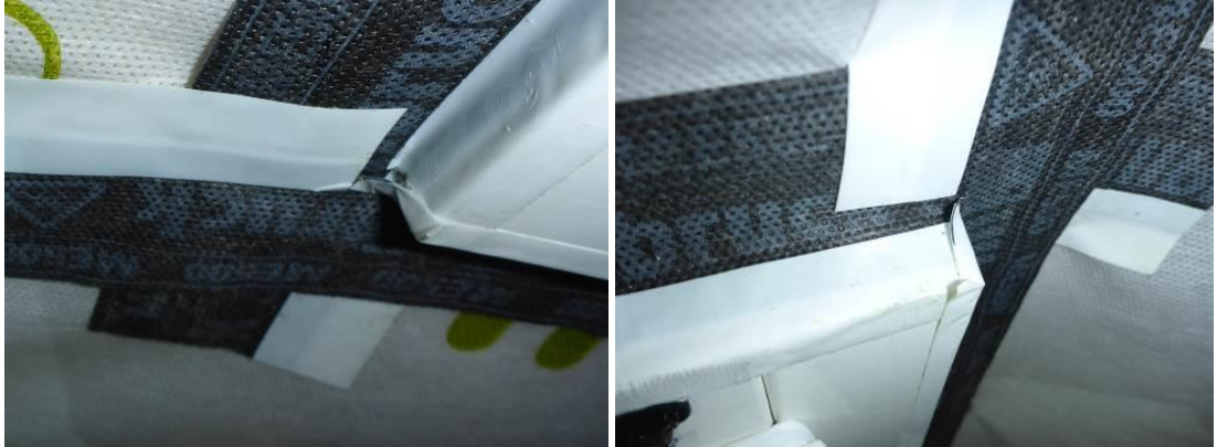
Kuvat 7 ja 8. Aistinvaraisessa tarkastelussa havaittiin useita ilmayhteyksiä liitosnauhojen taitoksissa, kohdissa, joissa liitosnauha taittuu höyrynsulkukalvon tasalta karmipinnalle.
