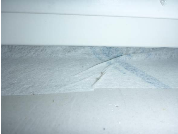
Kuva 10. Aistinvaraisessa tarkastelussa liitosnauhan pinnoilla havaittiin jonkin verran poimuuntumista. Poimut oli kuitenkin tasoitettu niin, että aistinvaraisesti ei mahdollisia ilmayhteyksiä liitoksen läpi voitu havaita.
