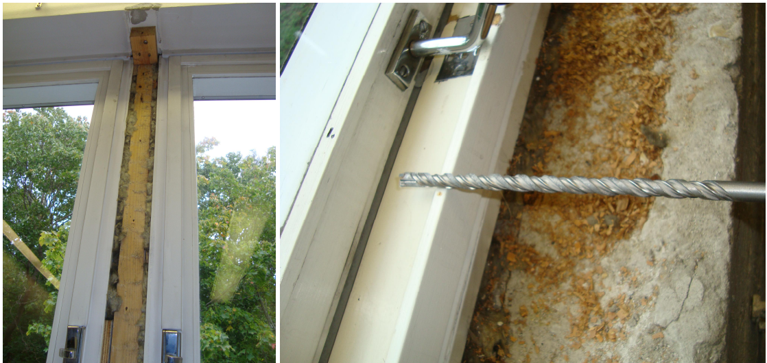
Kuva 10. Ikkunaliittymä 1970-luvulla rakennetussa kohteessa. Ikkunan ja ympäröivien rakenteiden väliset liittymät on täytetty mineraalivillalla. Peitelistan irrotuksen jälkeen mineraalivillan pinnassa havaittiin merkkejä ilmapuodoista rakenteen läpi. Ikkunapenkin pinta on epätasainen ja epätiviissä liittymässä on ilmayhteyksiä rakenteen lämmöneristekerrokseen. (Kuva: Mikko Koskivuori, Vahanen Rakennusfysiikka Oy.)
