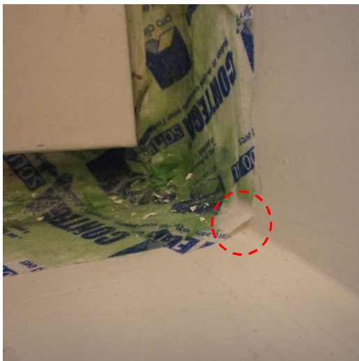
Kuva 19. Kuvan asennuksessa liitosnauha on asennettu siten, että nauha on pingottunut ikkuna-aukon pielen sisänurkan yli aiheuttaen nauhan irtoamisen alustastaan ja liittymän läpi on muodostunut ilmayhteys rakenteen ja sisäilman välille. Liitosnauhan nurkakohtaan on asennettu tiivistysmassaa, mutta massaa on sivelty vain liitosnauhan päälle, eikä liitosnauhan ja ikkunapielen rajapintojen ilmatiiviyttä ei ole varmistettu asentamalla tiivistysmassaa rajapinnan yli. Liitosnauhan alustastaan irronnut alue ja tästä muodostunut reikä liitoksen läpi on merkitty kuvaan punaisella katkoviivalla. (kuva: Tommi Syrjäläinen, Vahanen Oy.)
