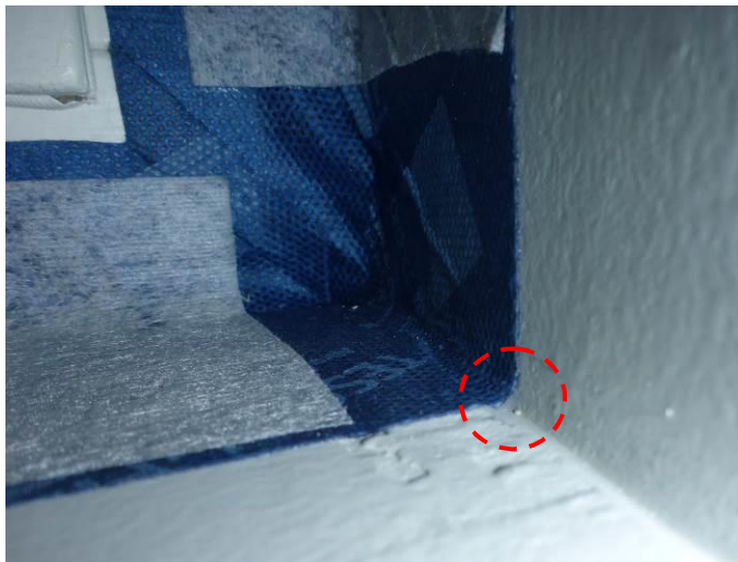
Kuva 8. Nurkkakappaleiden taitteen havaittiin olevan irti ikkunapielien nurkan pohjasta kaikkien nurkkien kohdalla.
