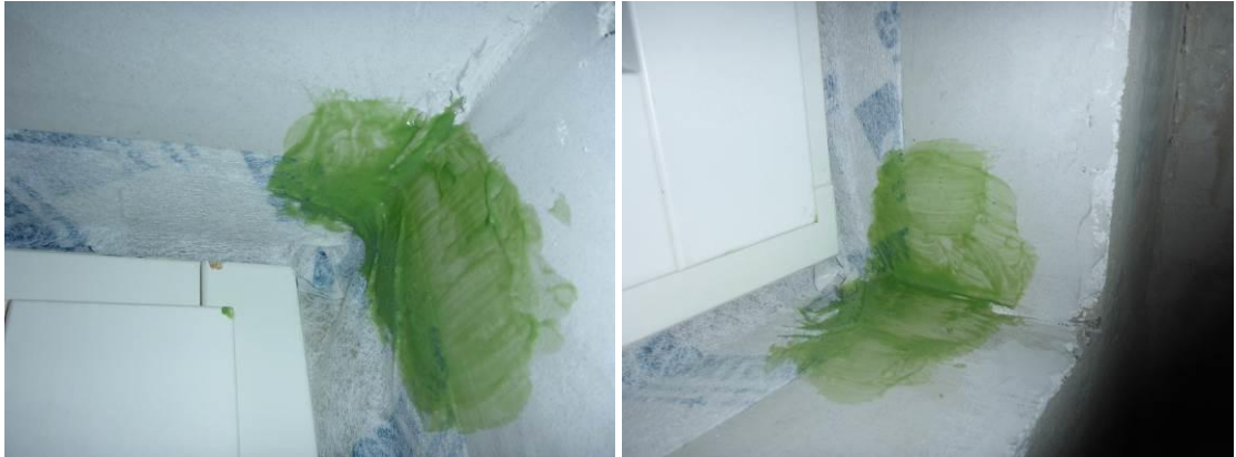
Kuvat 4 ja 5. Ikkunapielten nurkkiin siveltiin, liitosnauhan päälle pielen ja nauhan rajakohtaan siveltiin Wyflexa –tiivistysmassaa
