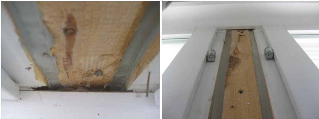
Kuva 14. Ikkunaliittymiä 1990-luvulla valmistuneessa kohteessa. Ikkunan ulkoseinärakenteen väliset rakenneliittymät on tiivistetty joustavalla saumausmassalla pohjanauhaa käyttäen. Rakenneavauksessa havaittiin, että joustavan tiivistysmassan takana on pohjanauha sekä polyuretaanivaahdotus. (Kuva: Mikko Koskivuori, Vahanen Rakennusfyysikka Oy.)
