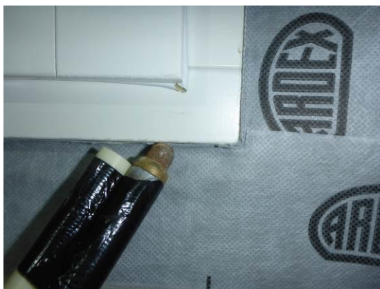
Kuvat 7. Merkkiainelaitteella havaittiin hyvin paikallisesti vähäistä vuotoa nauhan ja karmin sivupinnan liitoksesta. Aistinvaraisessa tarkastelussa vuotokohdassa ei havaittu poikkeavuuksia.
