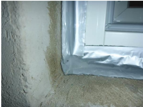
Kuva 2. Ikkunan nurkkaliitokset toteutettiin asentamalla eri sivujen liitosnauhat ristiin limittäen nauhat päällekkäin noin 20-40 mm.
