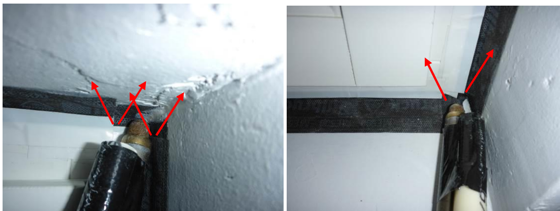
Kuvat 9 ja 10. Merkkiainelaitteella havaittiin ilmapuotoja kaikista nurkkakohdista. Vuotokohdissa oli ilmayhteyksiä liitoksen läpi nauhojen päissä, joissa ei ole yhtenäistä liimapintaa
