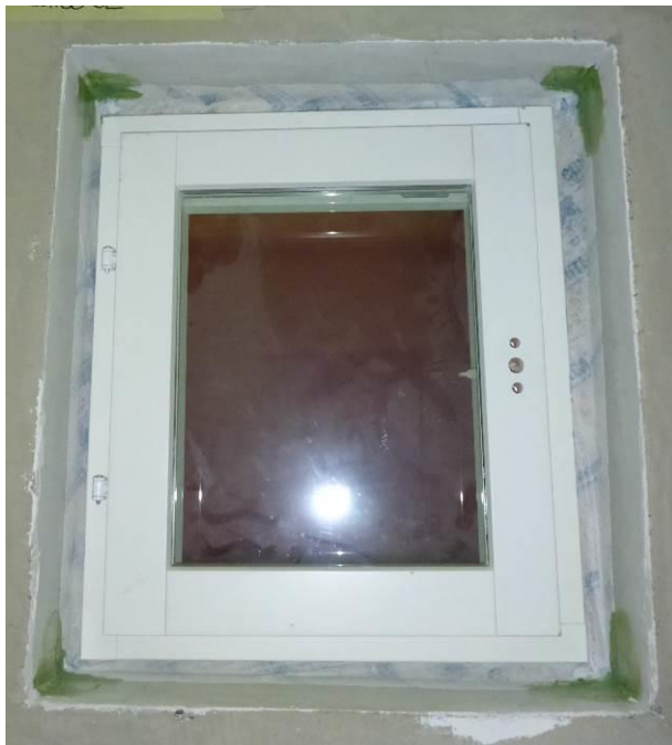
Kuva 1. Ikkunaliittymän tiivistys harkkorakenteisen seinän ikkuna-aukon pielten pintaan toteutettuna Contega Solido SL –liitosnauhalla ja Wyflexa –tiivistysmassalla.
