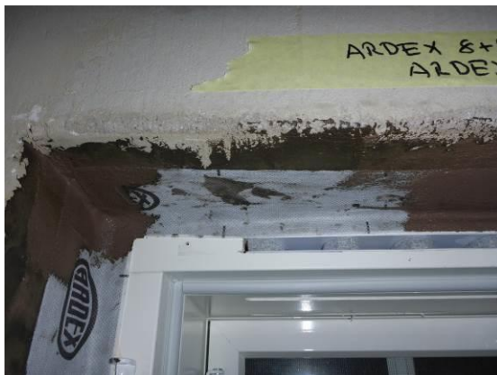
Kuva 2. Ikkunaliittymien nurkkakohdat toteutettiin limittämättä eri sivujen karminauhat noin 20 mm toistensa päälle ja nauhojen liittymäkohdat tiivistettiin Ardex 8+9 –vedeneristemassalla
