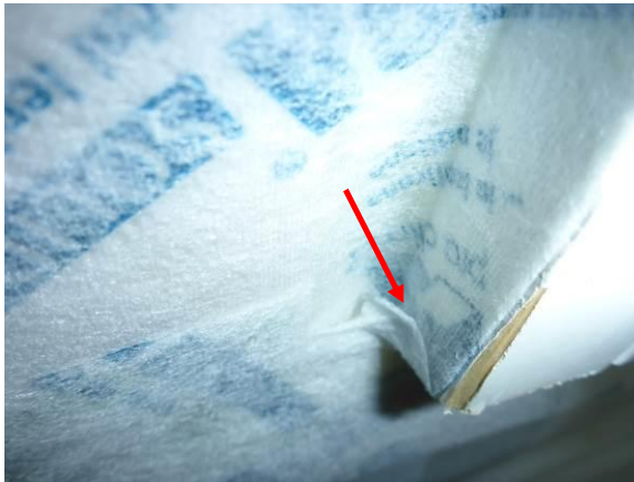
Kuva 8. Ikkunan alareunojen nurkkaliitoksissa havaittiin liitosnauhan auenneen nurkan yli taitetuista kohdista.
