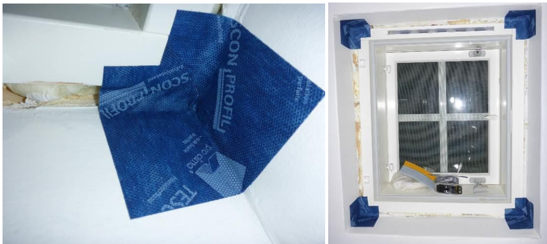
Kuvat 2 ja 3. Ikkunan nurkkaliitokset toteutettiin asentamalla nurkkakohtiin erilliset, muotoillut Tescon Incav –nurkkakappaleet.
