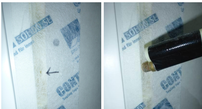
Kuvat 7 ja 8. Kaasun leviämistä rakenteessa varmistettiin tekemällä reikä liitosnauhan pintaan. Tehdystä reiästä havaittiin kaasun levinneen hyvin mallirakennuksen ulkoseinärakenteessa.
