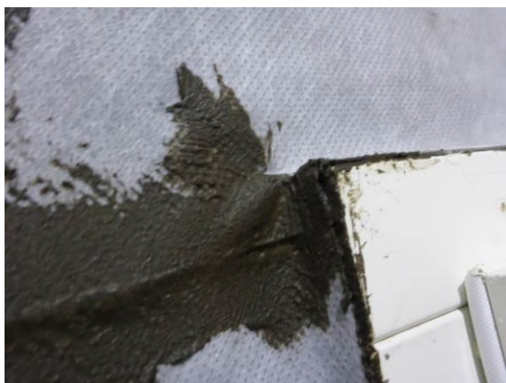
Kuva 6. Nauhan poimuuntumista havaittiin yhden nurkkaliitoksen kohdalla, vedeneristetyllä alueella.
