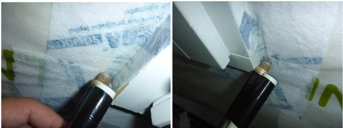
Kuvat 9 ja 10. Vähäistä vuotoa havaittiin ikkunan alareunojen nurkkaliitoksissa, joissa liitosnauhojen nurkan yli taitettujen liepeiden havaittiin myös aistinvaraisesti irronneen alustastaan
