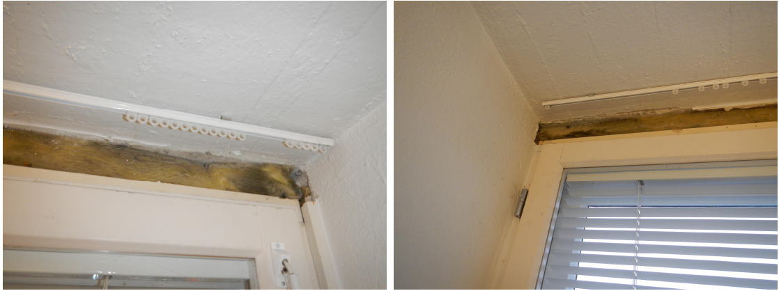
Kuva 9. Ikkunaliittymä 1960-luvulla rakennetussa ja vuonna 1997 peruskorjatussa kohteessa. Ikkunan ja ympäröivien rakenteiden väliset liittymät on täytetty mineraalivillalla. Peitelistan irrotuksen jälkeen mineraalivillan pinnassa havaittiin runsaasti merkkejä ilmapuodoista rakenteen läpi. (Kuva: Miia Pitkäranta, Vahanen Rakennusfysiikka Oy.)
