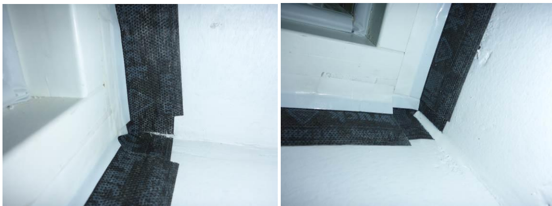
Kuvat 4 ja 5. Nurkkakappaleiden päälle, ikkunapielen nurkkaan, pielen ja nurkkakappaleen rajapintaan asennettiin SP 525 -tiivistysmassa.
