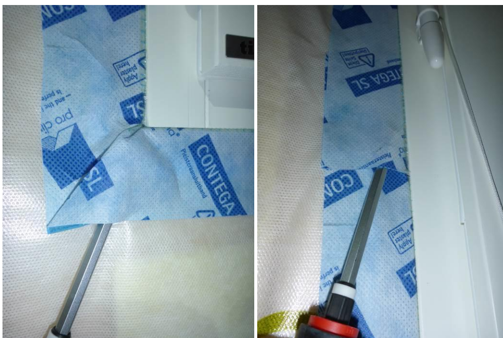
Kuvat 12 ja 13. Ilmayhteyksiä liitoksen läpi havaittiin nurkissa, joissa liitosnauha oli laskostettu taittaen nurkan muotoon sekä liitosnauhan limityskohdassa, jossa nauhan päät oli yhdistetty.
