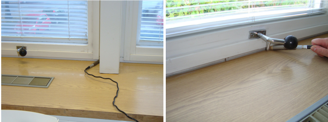
Kuva 11. Merkkiainekoe kuvassa 10 esitettyyn ulkoseinärakenteeseen. Merkkiainekokeessa havaittiin ilmapuotoja lämmöneristekerroksesta huonetilaan kaikissa tutkituissa ikkunaliittymissä. Merkkiainekoe toteutettiin rakennuksen normaalissa käyttötilassa, ilman huonetilan alipaineistusta. (Kuva: Mikko Koskivuori, Vahanen Rakennusfysiikka Oy.)
