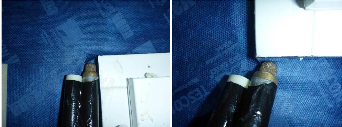
Kuvat 8 ja 9. Voimakasta vuotoa havaittiin ikkunan nurkkaliitoksissa, joissa teipin nurkan yli taitettujen liepeiden havaittiin myös aistinvaraisessa tarkastelussa irronneen alustastaan
