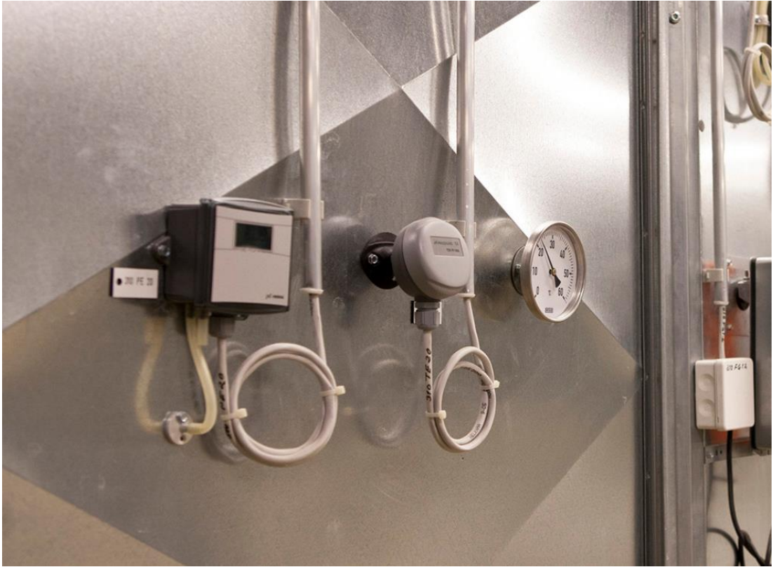
Kuva 1. Pro dual Oy:n valmistamia mittalaitteita ilmanvaihtokanavaan asennettuina (Pro dual Oy s.a.b).
