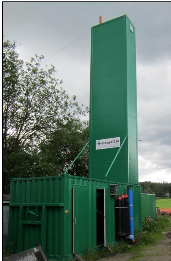
KUVA 5. Metener Oy:n biokaasun puhdistuslaitteisto Kalmarin tilalla Laukaassa (Koljander 2016)
