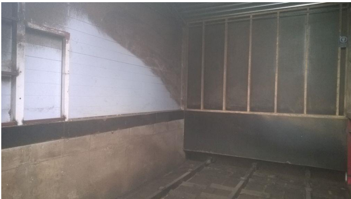
Kuva 3. Enon yläkylän voimalan hakevarasto (Kuva: Pekka Penttinen).
