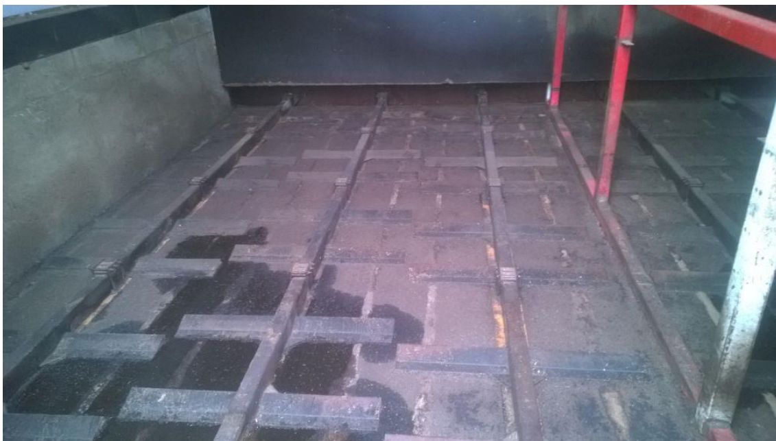
Kuva 4. Enon yläkylän voimalan tankopurkaimet (Kuva: Pekka Penttinen).
