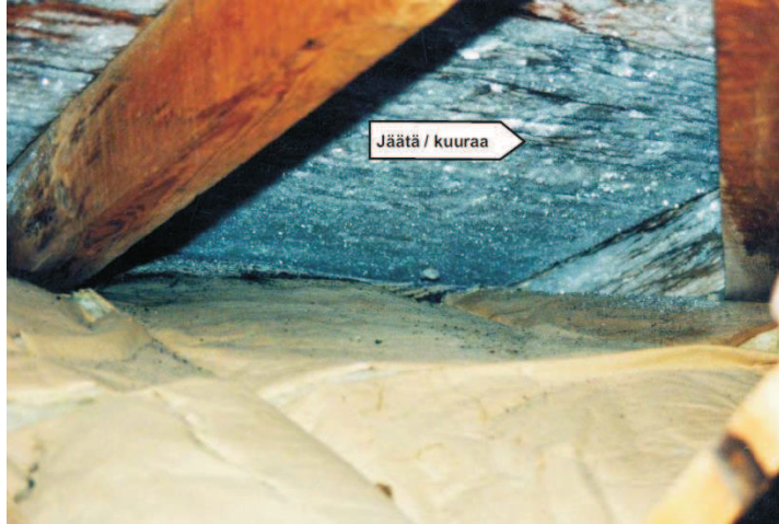
Kuva 4. Kosteus on muodostunut jääksi ja kuuraksi yläpohjarakenteisiin (Ympäristöministeriö 2012, 99).
